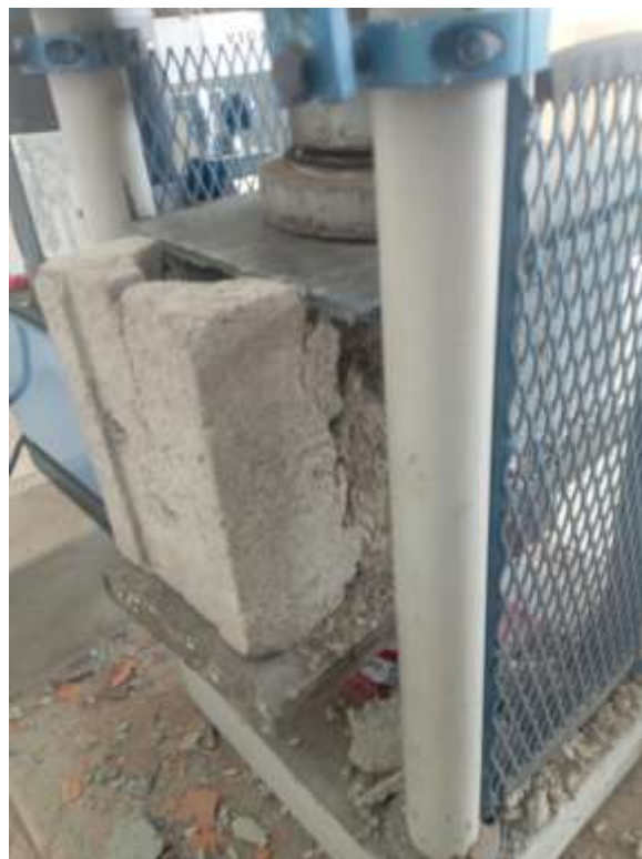
Fotografía 14. Rotura de bloquetas.
