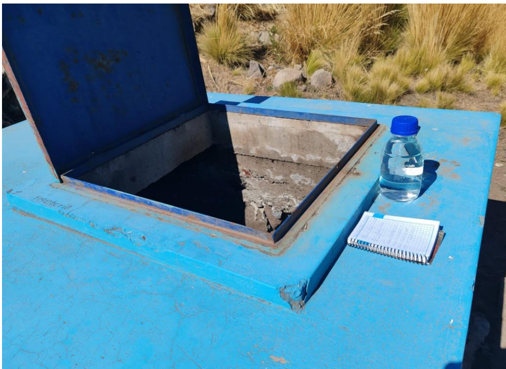
Figura 06: visualización de una muestra de agua en el sistema de captación.
