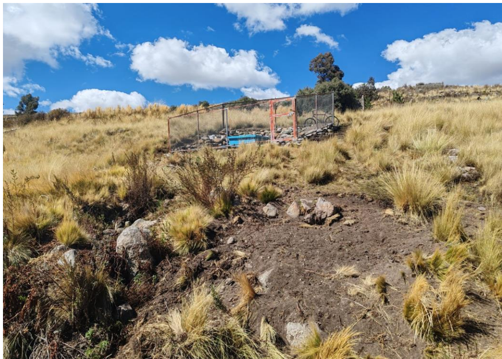
Figura 02: visualización panorámica del sistema de captación de agua del CP Villa Poccona.
