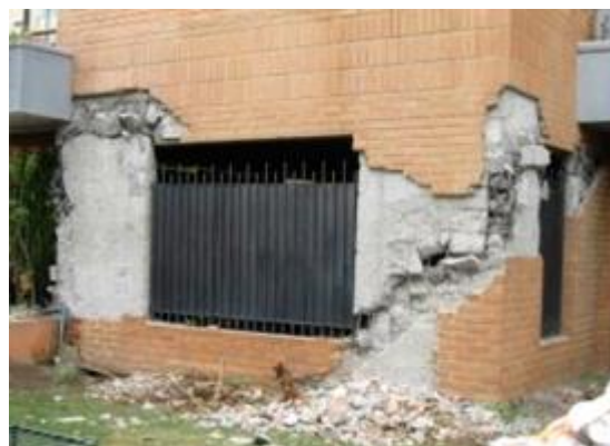
Falla por tensión diagonal en muro estructural
