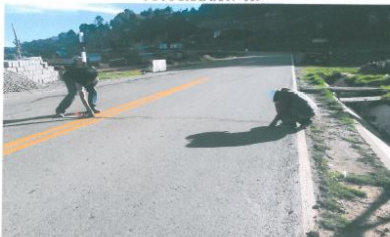
Falta Señalización Horizontal
