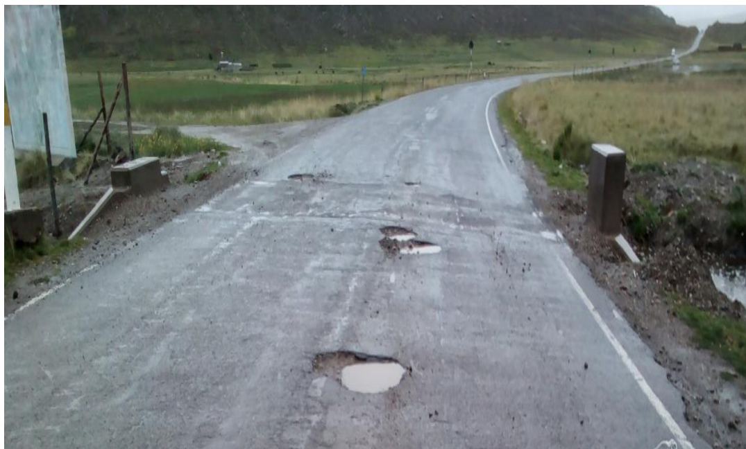
Falta de Parchado en la Calzada Falta Señalización Horizontal
