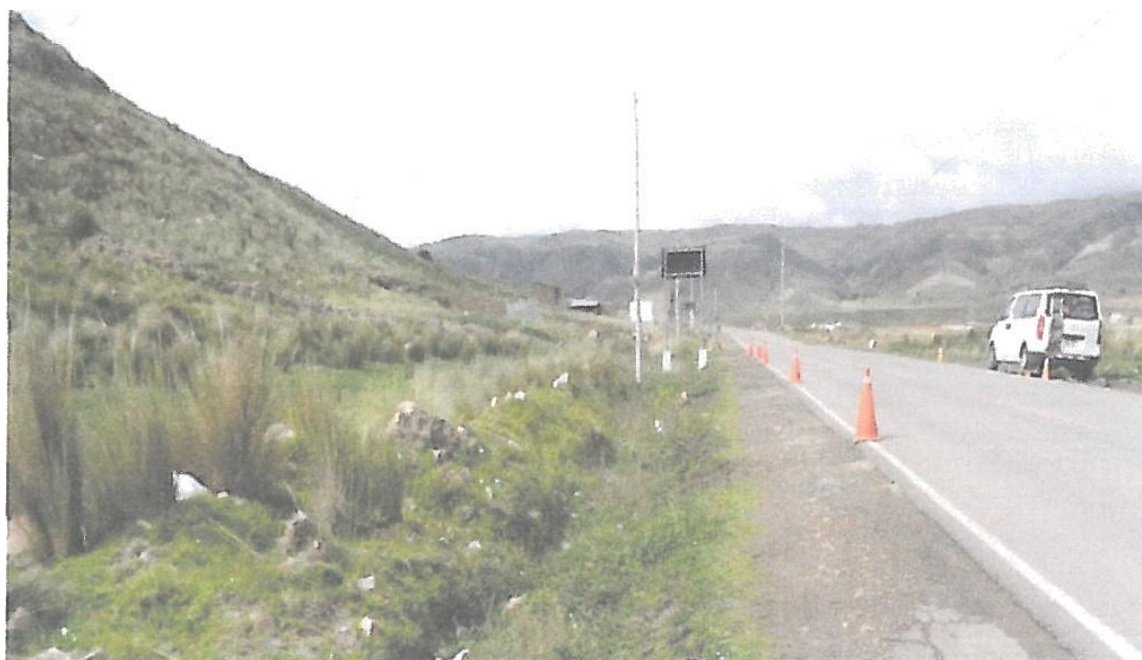
Falta Señalización Horizontal
