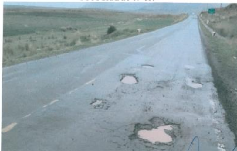
Falta de Parchado en la Calzada
