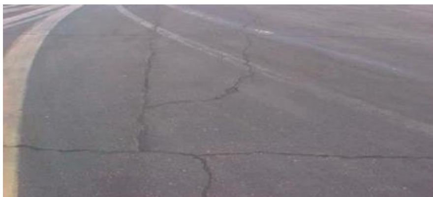
Fisuras en bloque
