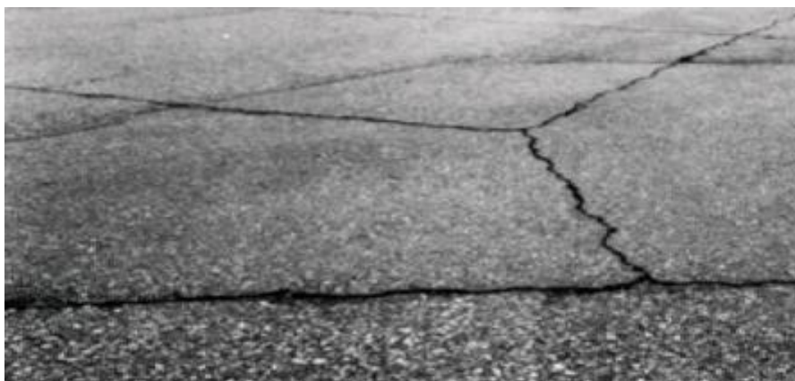
Fisura de reflexión
