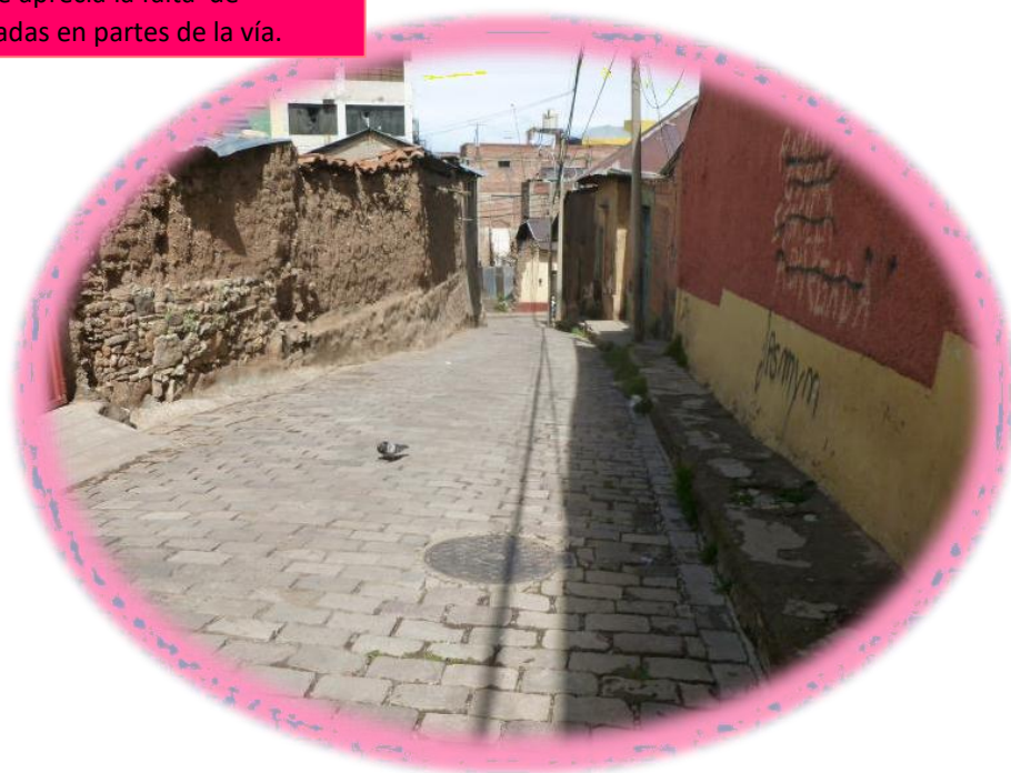
FOTOGRAFÍA N° 4: FRACTURACIÓN EN EL JR. BOLOGNESI.- Se observa unidades segmentadas fracturadas.
