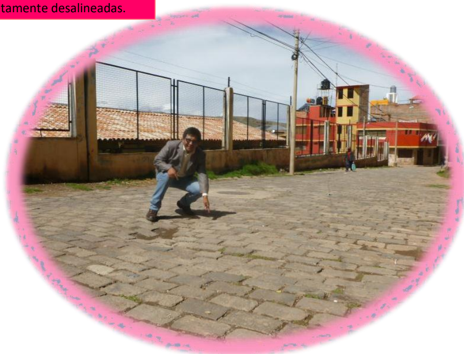
FOTOGRAFÍA N° 6: DESPLAZAMIENTOS EN EL JR. BOLOGNESI.- Se observa las unidades segmentadas completamente desalineadas.
