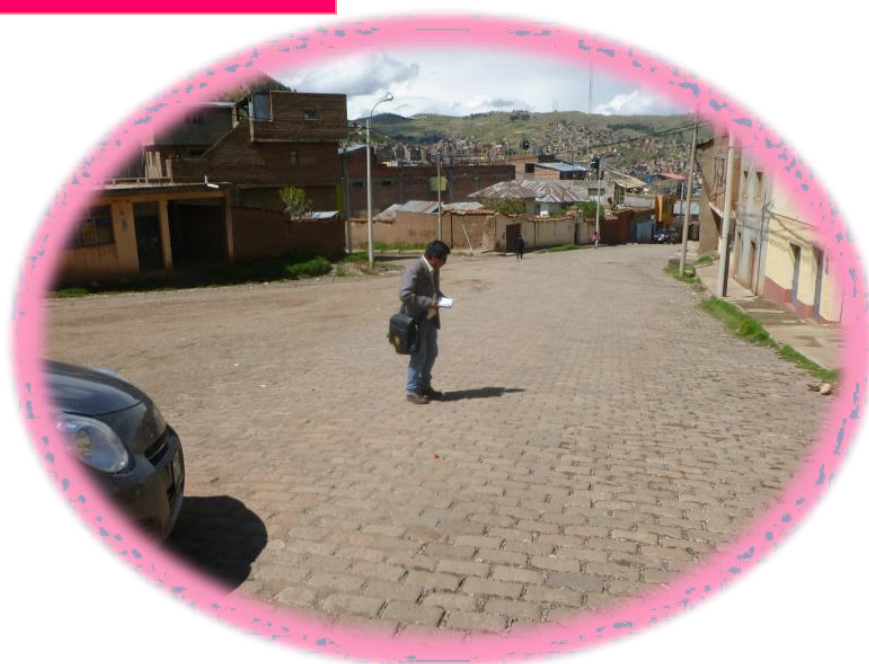
FOTOGRAFÍA N°24: DEFORMACIONES EN EL JR. BOLOGNESI.-La excesiva pendiente no permite el control de la rasante de la vía.
