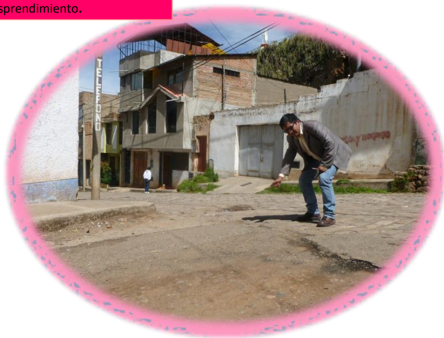
FOTOGRAFÍA N° 15: DESPRENDIMIENTOS EN EL JR. BOLOGNESI.- El cambio de pavimento con las vías de intersección originan desprendimiento.
