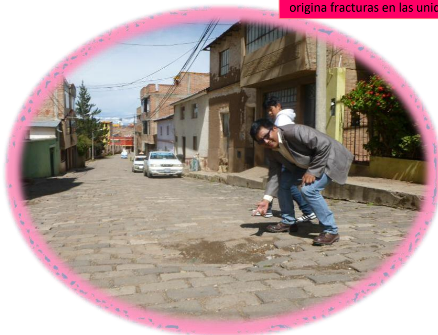
FOTOGRAFÍA N° 13: FRACTURACIÓN EN EL JR BOLOGNESI.- La deficiente conformación de la base origina fracturas en las unidades segmentadas.
