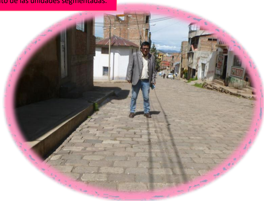
FOTOGRAFÍA N° 17: DESPRENDIMIENTOS EN EL JR. BOLOGNESI.- El deficiente diseño de obras de drenaje origina el desprendimiento de las unidades segmentadas.
