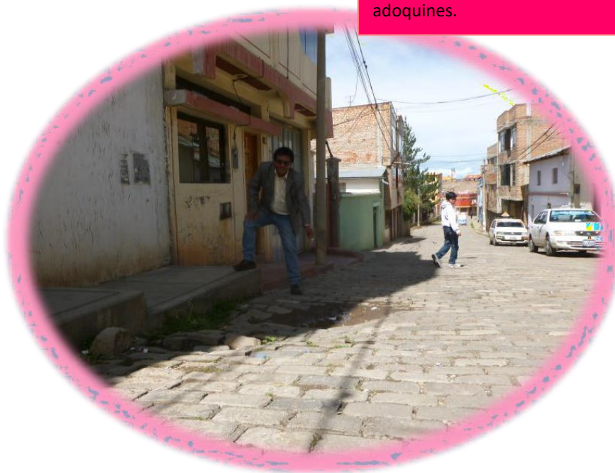
FOTOGRAFÍA N°12: ESPLAZAMIENTOS EN EL JR. BOLOGNESI.- El desalinamiento alineado y desalineado del ancho de la vía origina desplazamientos en los adoquines.
