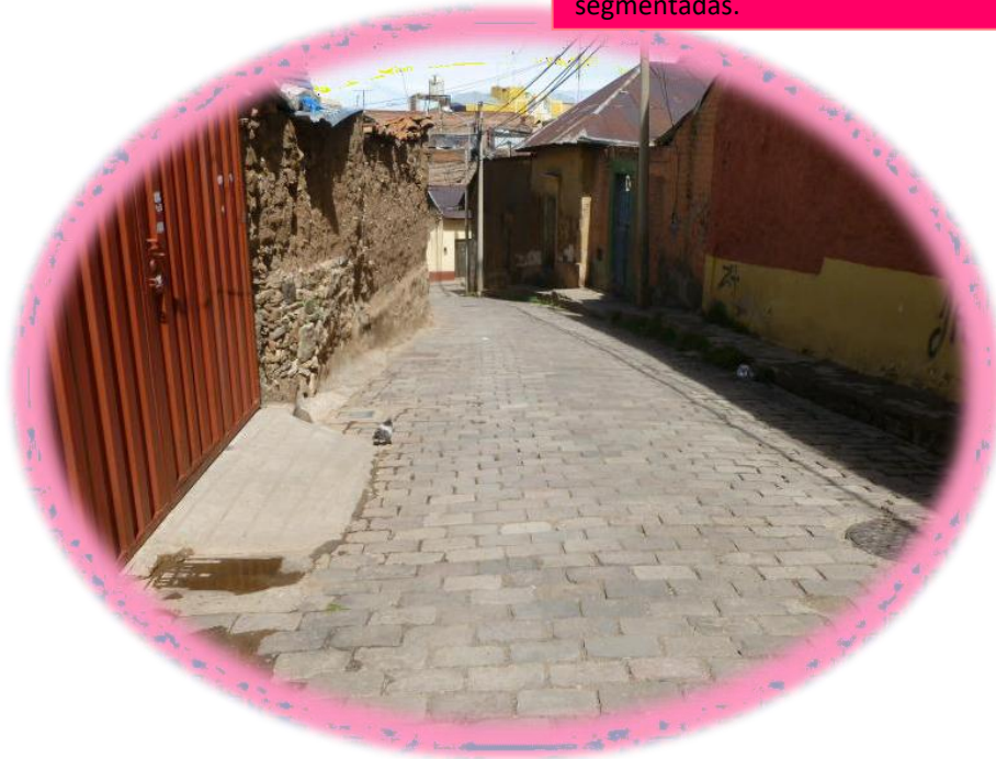
FOTOGRAFÍA N° 1: DESPLAZAMIENTOS EN EL JR. BOLOGNESI.- Se aprecia la desnivelación de unidades segmentadas.
