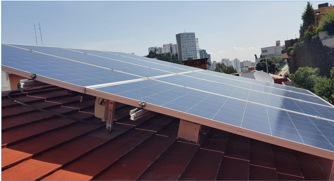
Figura 21. Ejemplo de estructura inclinada sobre un techo.
