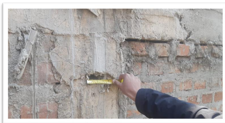
Imagen N° 08: Se observa las cangregeras en la columna.
