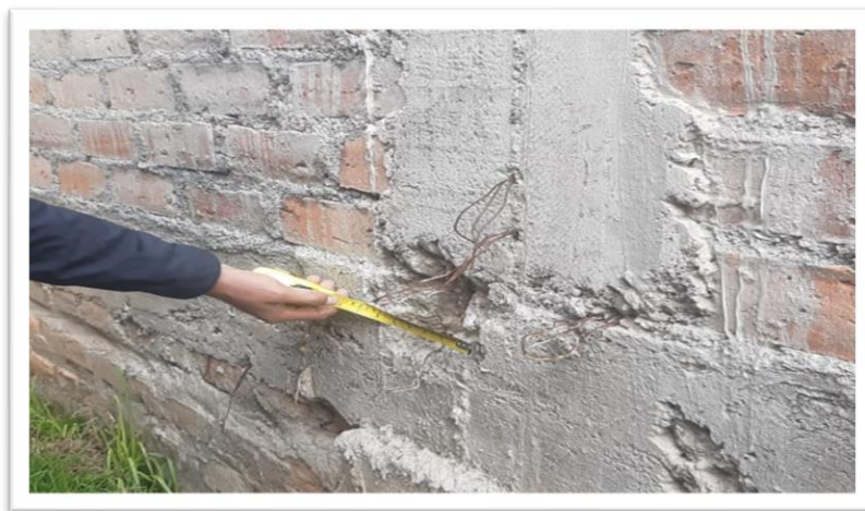
Imagen N° 05: se observa presencia de canjregera entre el sobrecimiento y columna.
