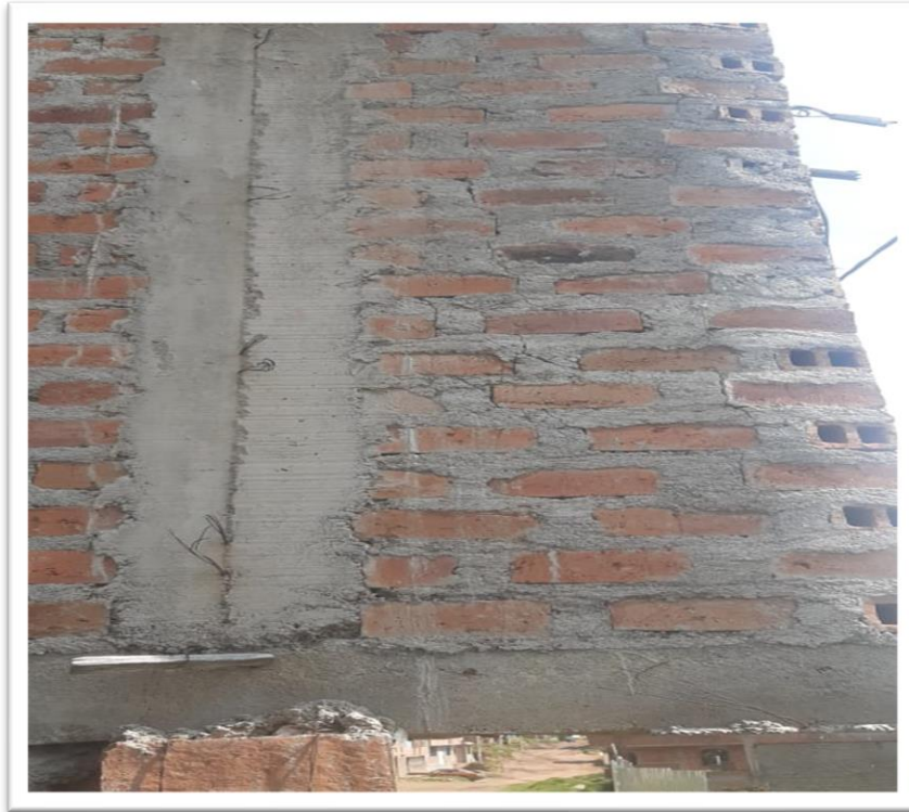
Imagen N° 10: Se observa las fisuras en el muro de albañilería.
