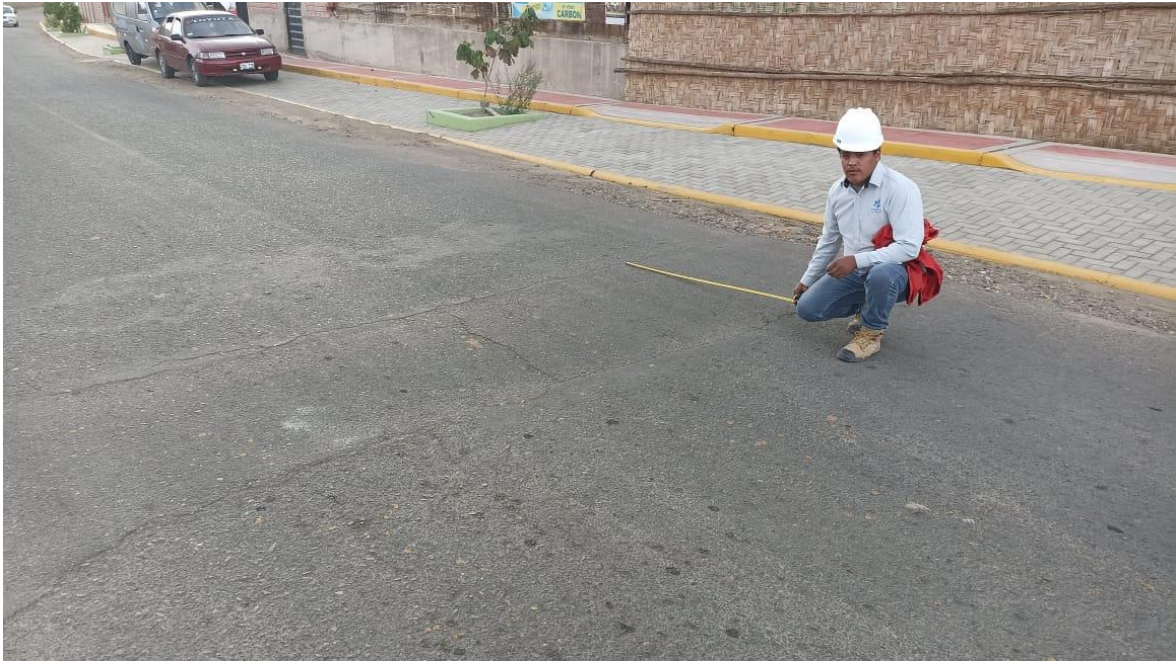
Ilustración 7 : Tipo de fallo - bloques
