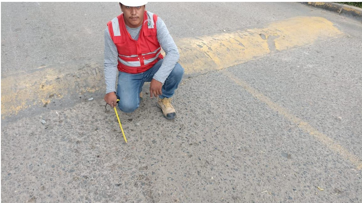
Ilustración 18 : Tipo de fallo – pulimiento de agregados
