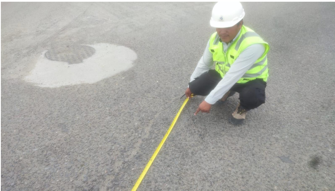
Ilustración 20: Tipo de fallo – pulimiento de agregados.
