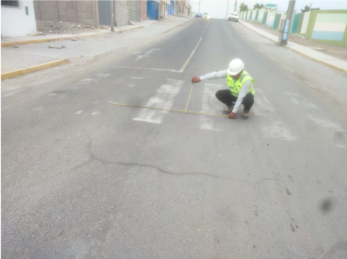
Ilustración 27: Tipo de fallo – Ahuellamiento.
