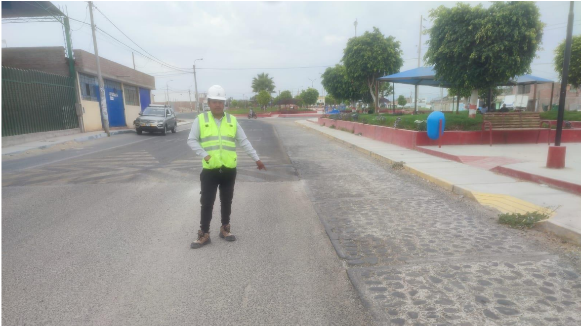
Ilustración 11: Tipo de fallo - desnivel
