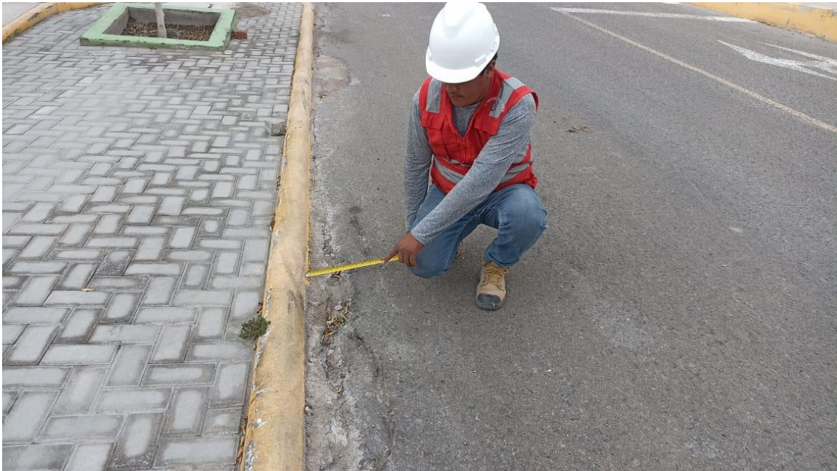
Ilustración 9 : Tipo de fallo - grieta de bordes.
