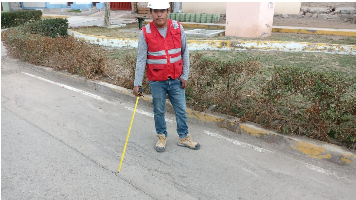
Ilustración 8 : Tipo de fallo - Grieta de bordes.
