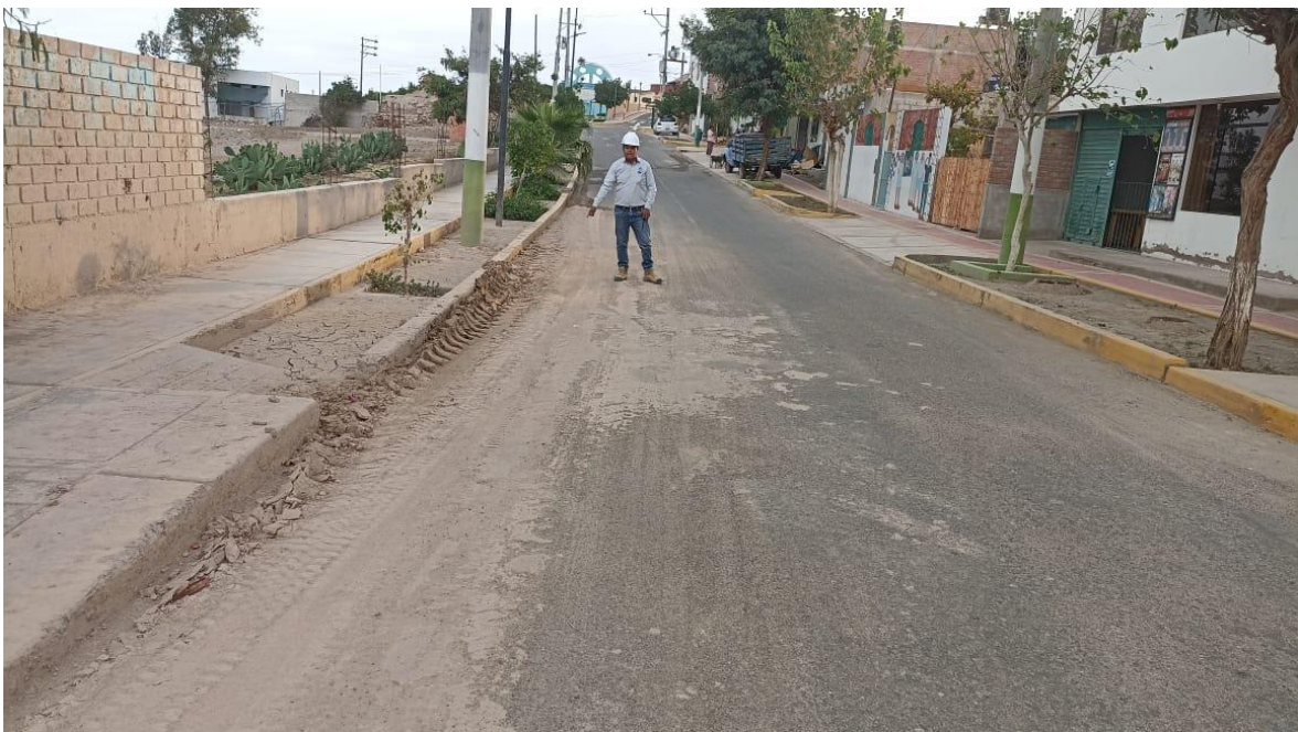
Ilustración 28: Tipo de fallo – Ahuellamiento.
