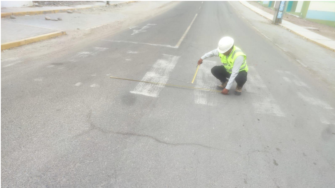
Ilustración 13 : Tipo de fallo – grietas transversales y longitudinales.
