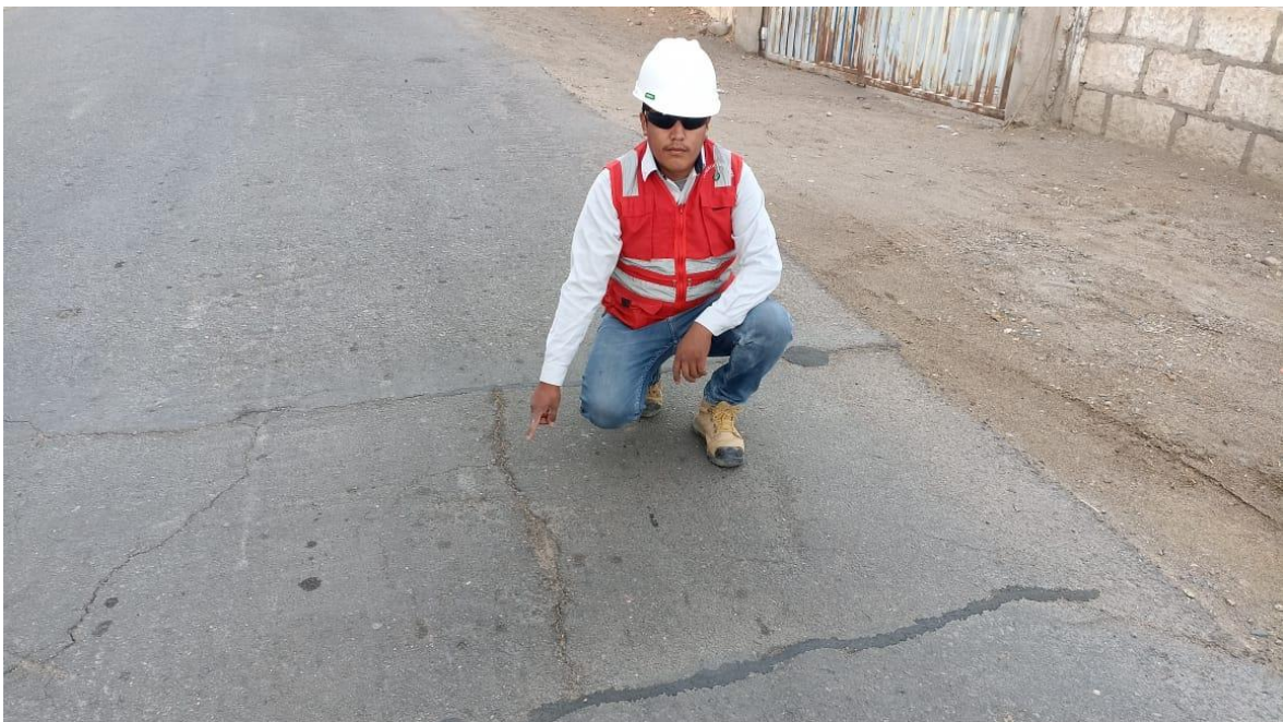
Ilustración 6 : Tipo de fallo – bloques.
