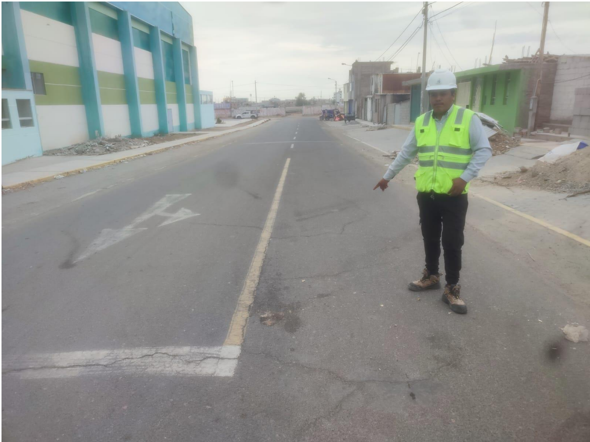
Ilustración 29: Tipo de fallo – grieta parabólica.
