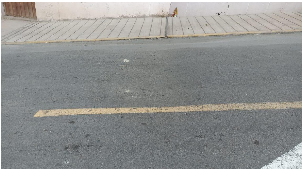
Ilustración 10 : Tipo de fallo – desnivel.
