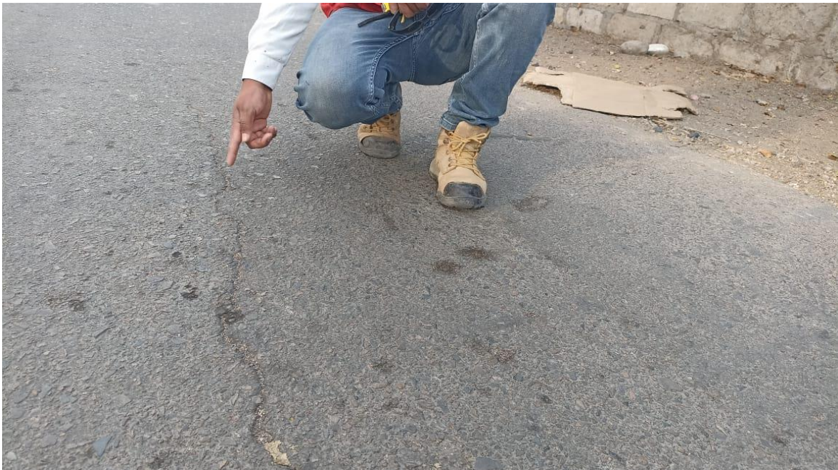
Ilustración 12: Tipo de fallo – grietas transversales y longitudinales.
