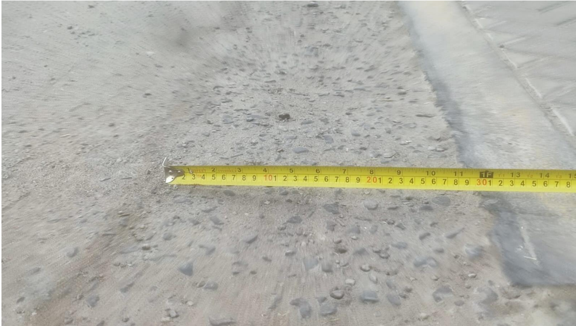
Ilustración 19: Tipo de fallo – pulimiento de agregados.
