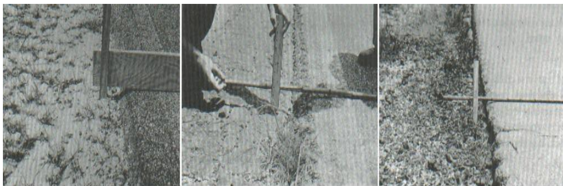
Desnivel carril / berma de baja severida (L) Desnivel carril / berma de junta de severidad media (M) Desnivel carril / berma de junta de alta severidad (H)
