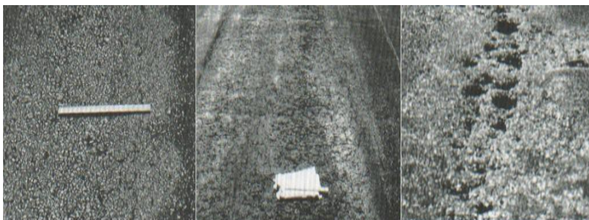
Desprendimiento de agregados de baja severidad (L) Desprendimiento de agregados de severidad media (M) Desprendimiento de agregados de alta severidad (H)
