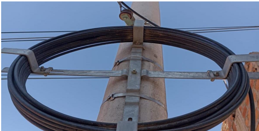
Cruceta de Fibra Óptica
