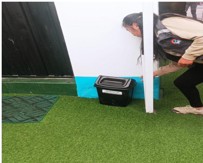
Fotografía 6. Instalación de contenedores para la gestión correcta de desechos sólidos en el segundo comedor del Eco Restaurante "Cevichería Las Brujas Pescados & Mariscos" del distrito de Puno.
