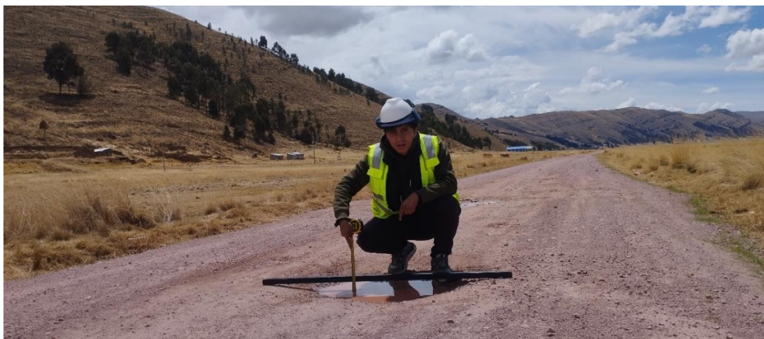
Fotografía 11. Baches(huecos) grado 2 entre el km 17+370 y el km 17+440
