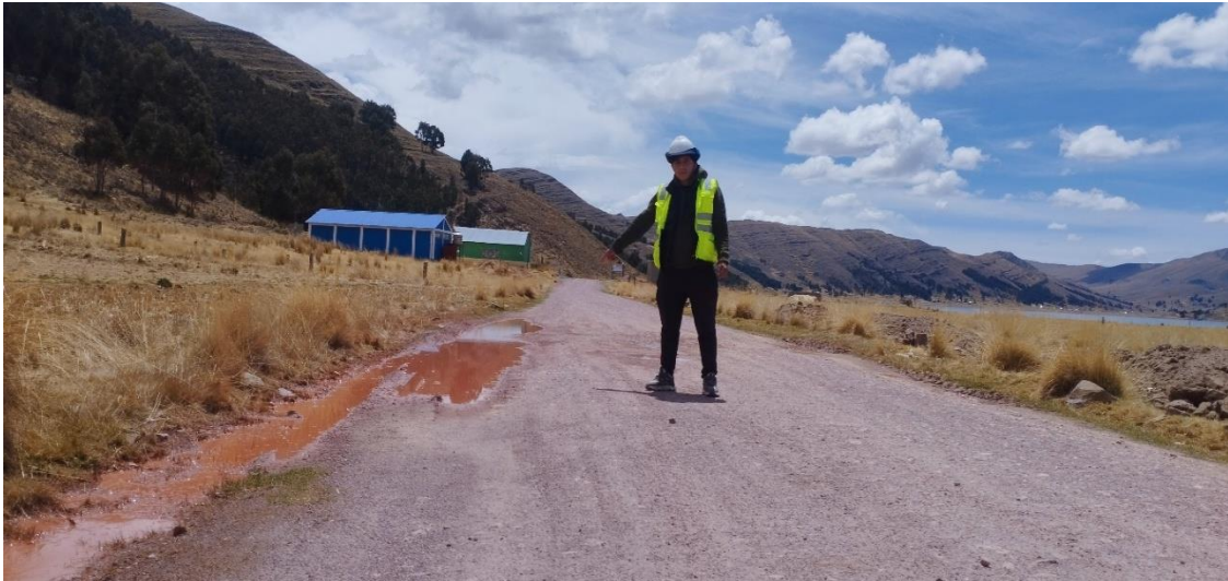
Fotografía 5. Erosión grado 1 entre el km 16+960 y el km 16+970
