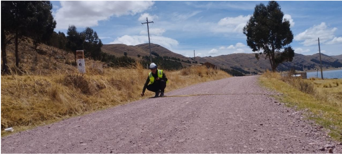
Fotografía 2. Lodazal grado 3 entre el km 16+170 y el 16+180
