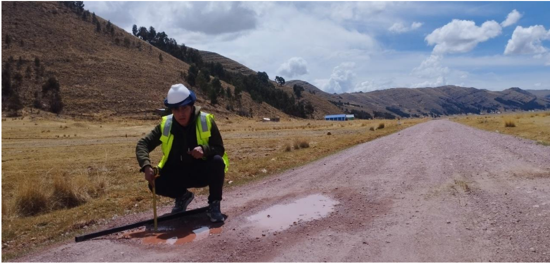
Fotografía 8. Erosión grado 2 entre el km 17+090 y el km 17+100
