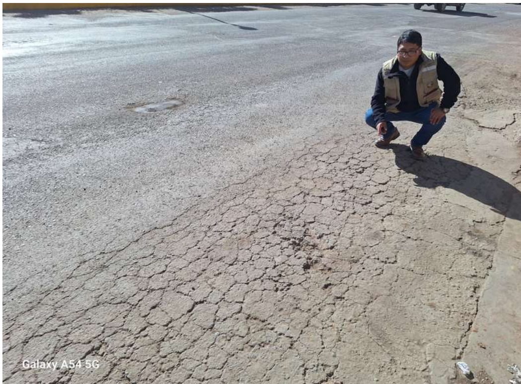
Fotografía 4. Falla de piel de cocodrilo
