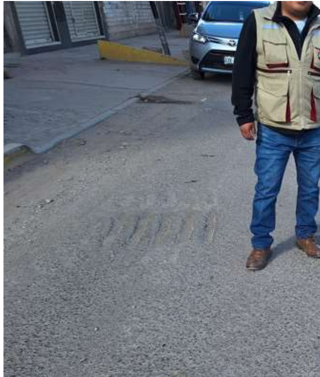
Fotografía 5. Falla de ahullamiento
