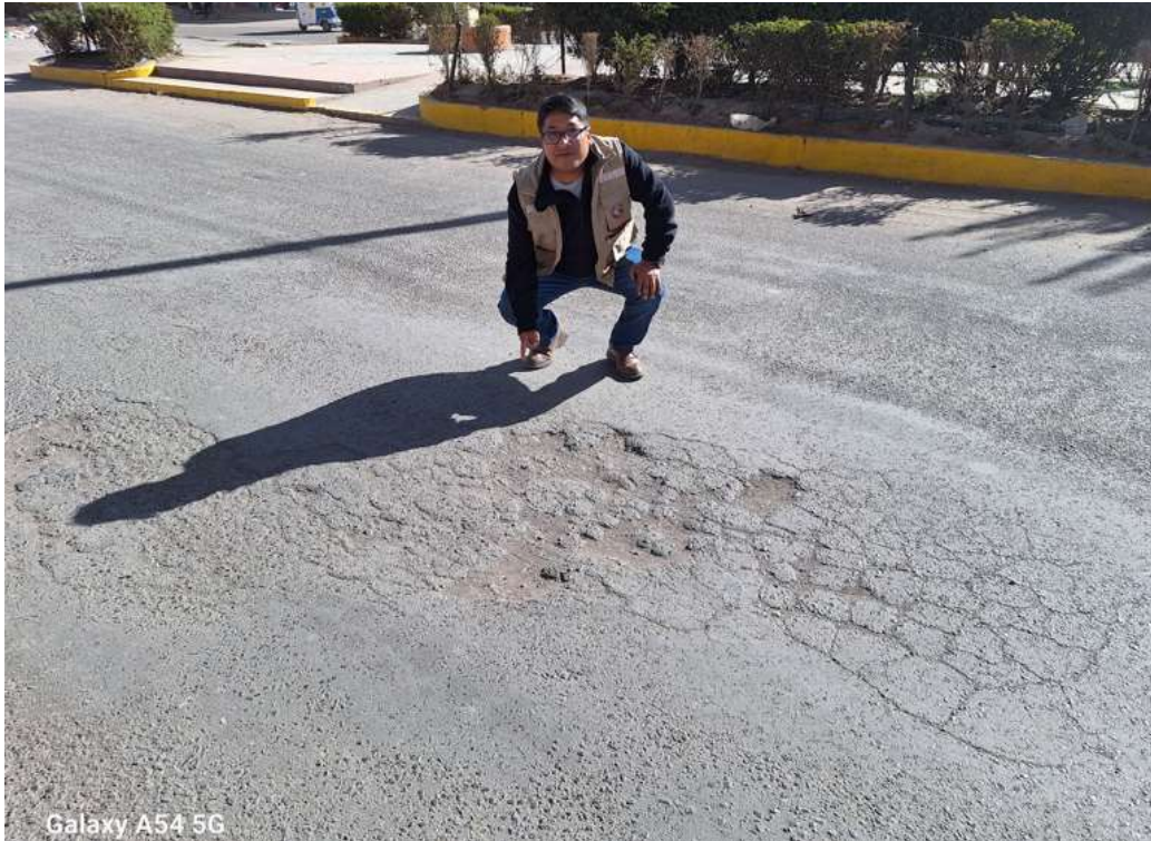
Fotografía 3. Falla de piel de cocodrilo
