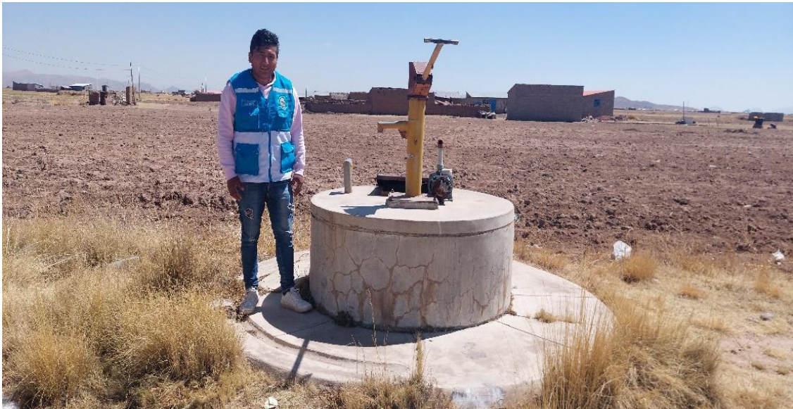
Figura 1: Pozo tubular de agua subterránea sector Jila Huancasayani
