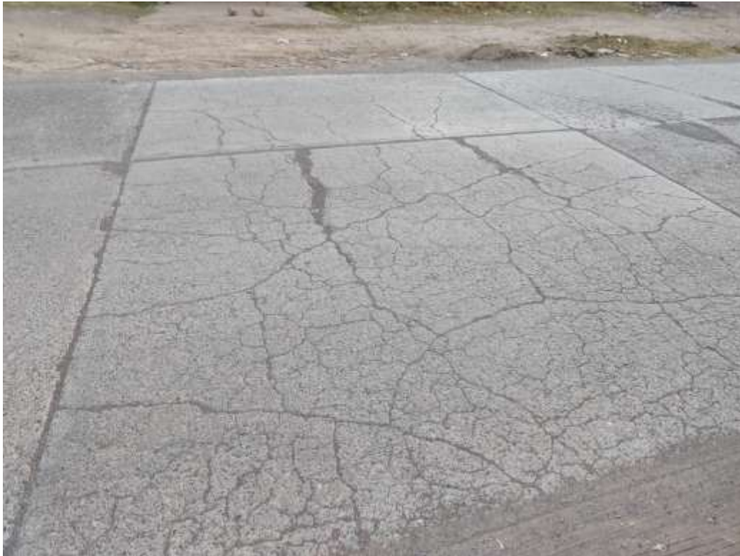
Fotografía 3. Se observa las Fallas 22, 25 y 28 (grieta de esquina, escala y grietas lineales), ubicado en el tramo 1+8000-1+860 km.
