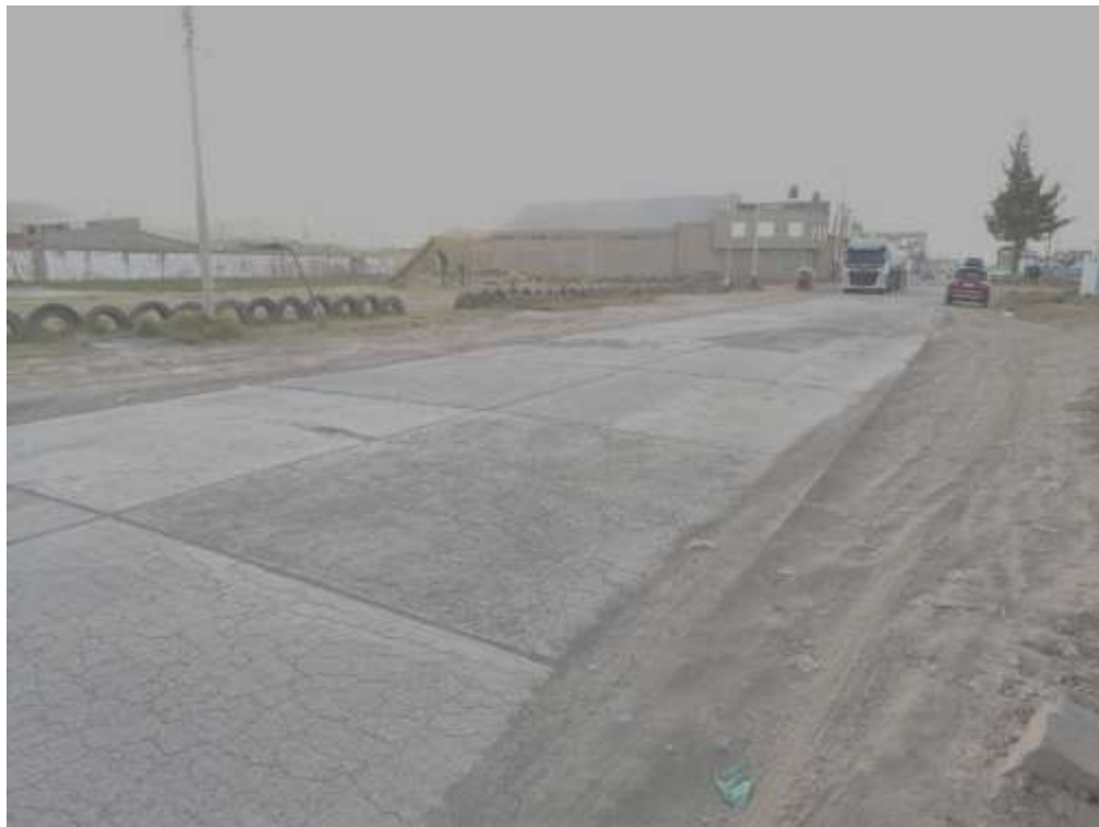
Fotografía 4. Se observa la Falla 31 (pulimiento de agregados), ubicado en el tramo 2+4000-2+460 km.
