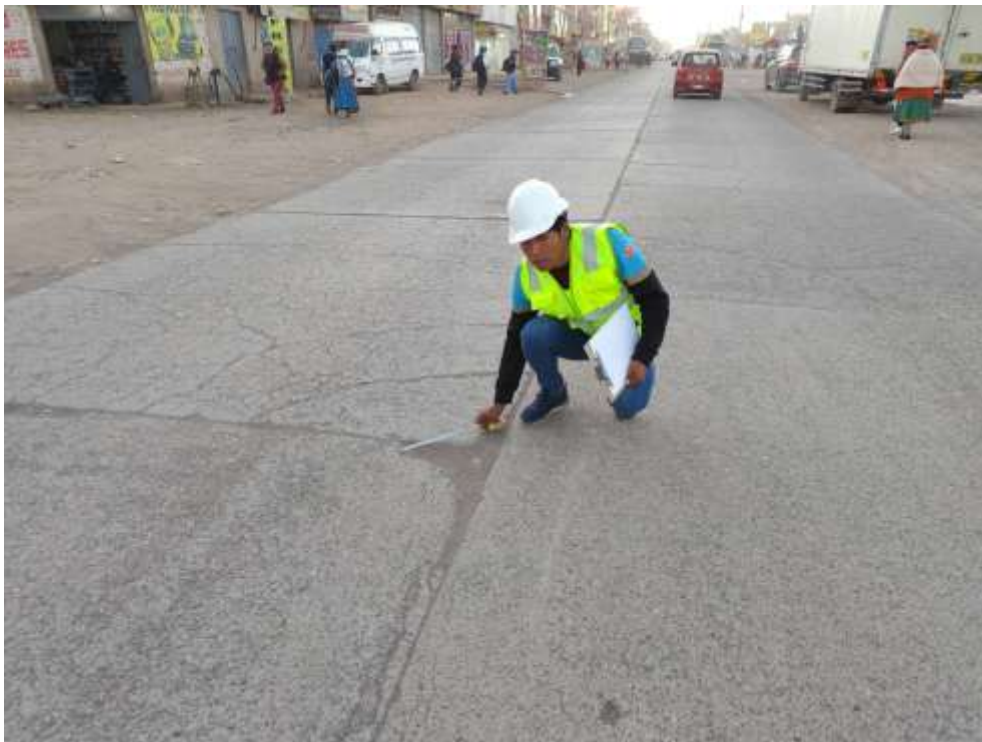
Fotografía 2. Se realiza la medición de la Falla 22 (grieta de esquina), ubicado en el tramo 1+200-1+260 km.
