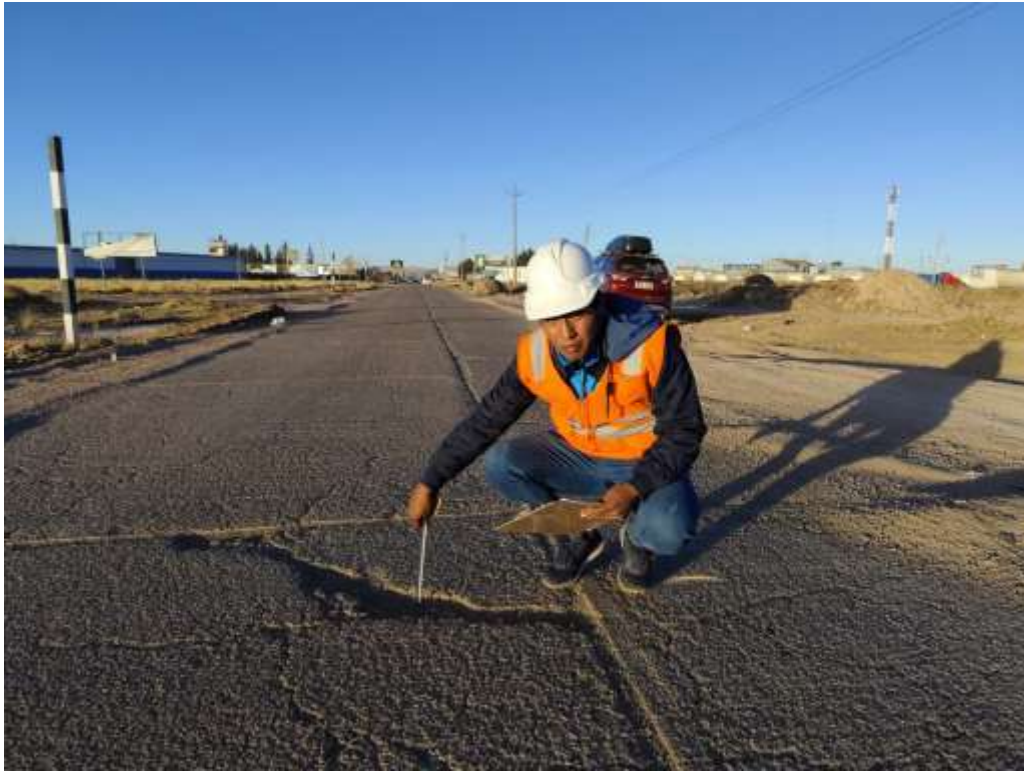
Fotografía 5. Medición de la Falla 22 (grieta de esquina), ubicado en el tramo 2+4000-2+460 km.
