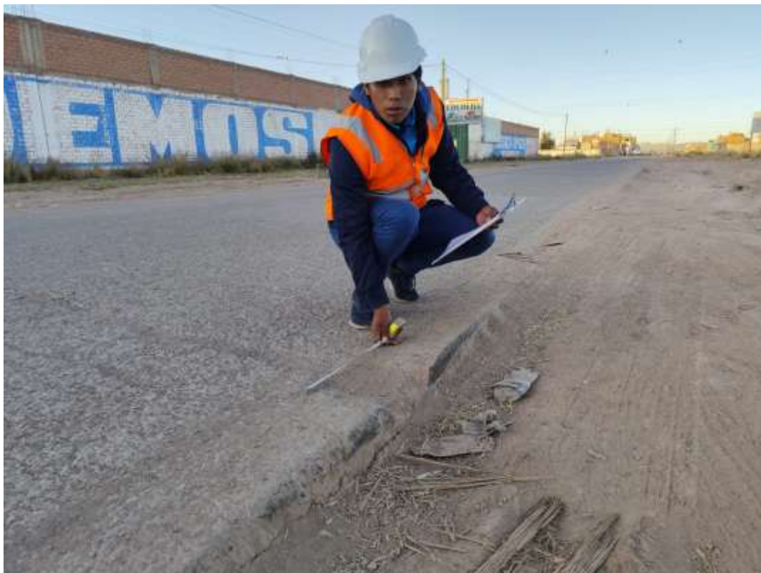
Fotografía 6. Medición de la Falla 25 (Escala), ubicado en el tramo 2+4000-2+460 km.
