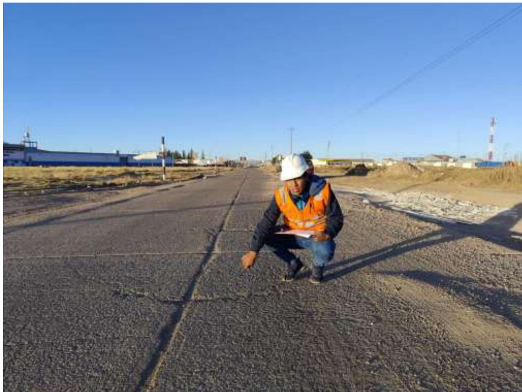
Fotografía 10. Fallas de severidad media
