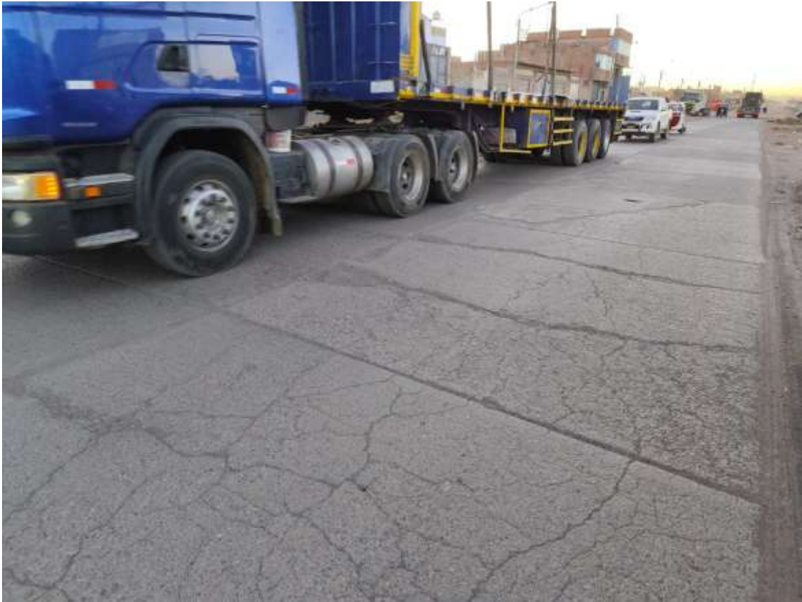
Fotografía 11. Vista de la incomodidad de tránsito debido a las fallas
