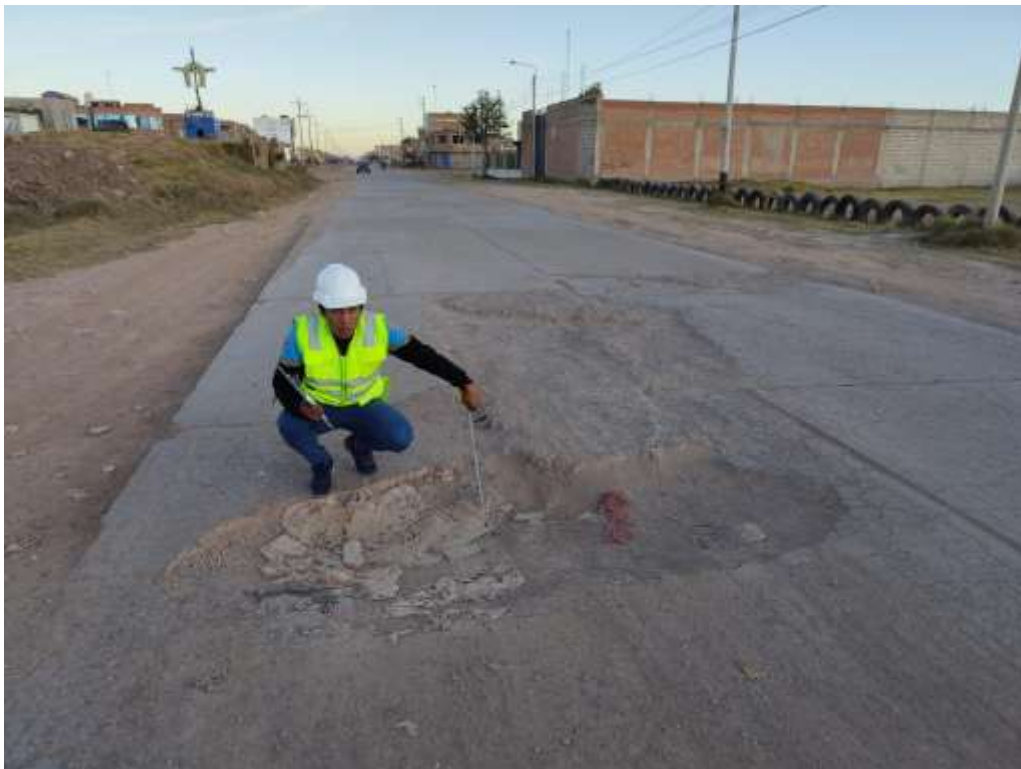
Fotografía 8. Fallas de severidad alta
