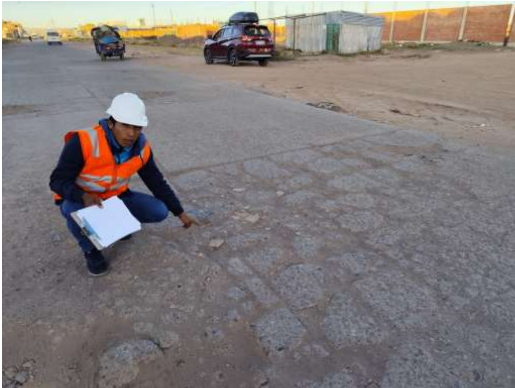
Fotografía 9. Fallas de la losa del pavimento rígido
