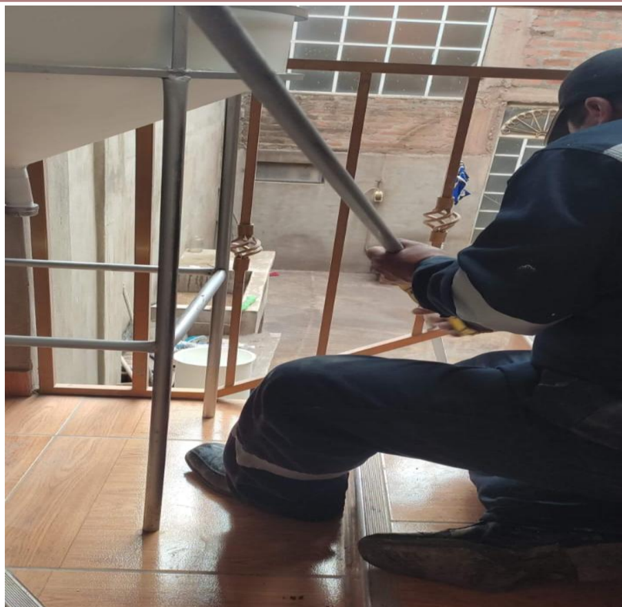
Fotografía 3. Etapa de instalacion del sistema de tratamiento fisico quimico
