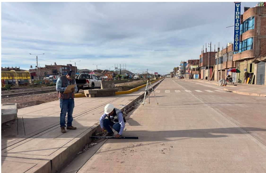
Fotografía 2.- Evaluación en campo del daño en la pavimentación causado por el desborde de las cunetas durante eventos de lluvia.
