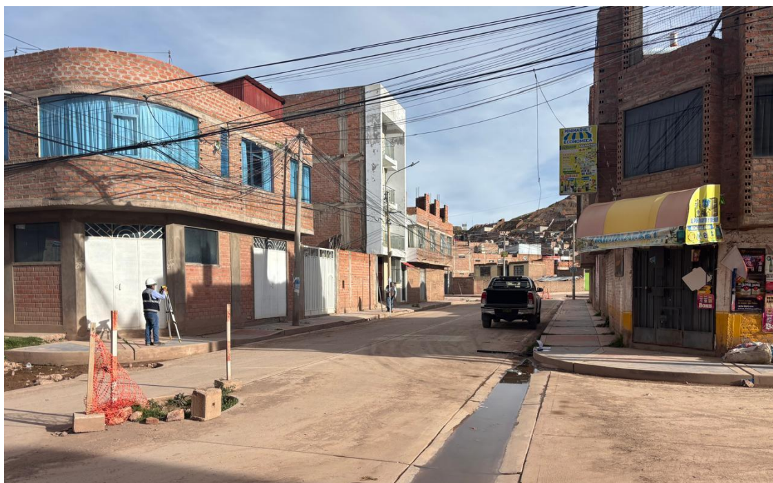
6.- Evaluación en campo de deficiencias de diseño de pendiente y/o del proceso constructivo que afectan el funcionamiento hidráulico de las cunetas.
