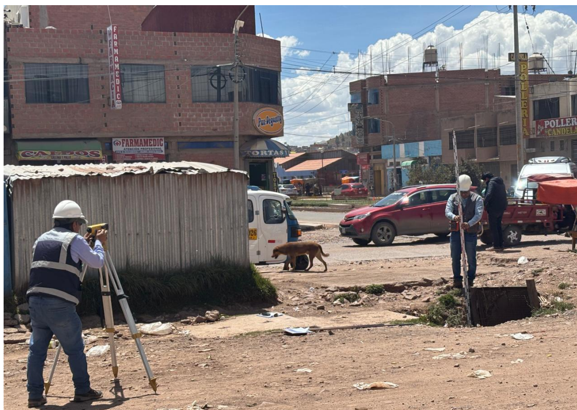
Fotografía 6.-Comprobación in situ de las dimensiones reales de las cunetas de concreto, ) y evaluación del estado físico de conservación y mantenimiento de la cuneta.
