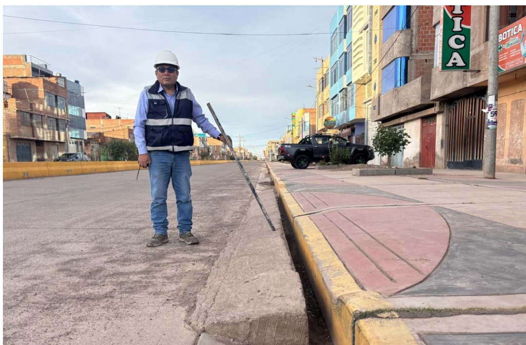
Fotografía 2.- Verificación en campo de elementos de concreto que reducen la sección hidráulica y afectan la conducción del flujo pluvial en la cuneta.
