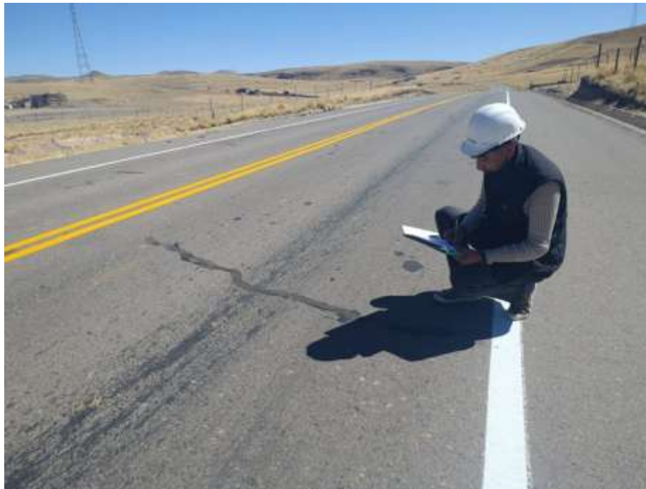
Fotografía 5. Grieta Longitudinales / Transversales en la vía.
