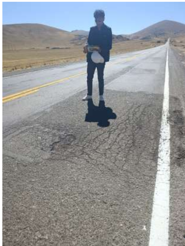
Fotografía 4. Ahuellamiento en la vía.
