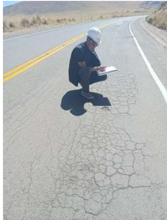
Fotografía 1. Falla piel de cocodrilo identificada.
