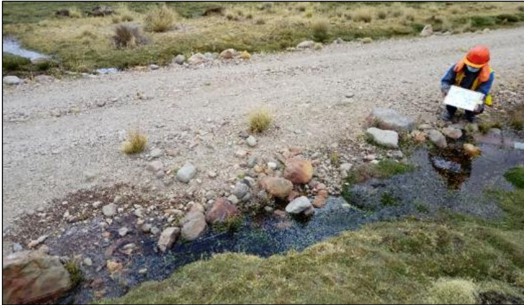
Fotografía 14. La fotografía muestra un deterioro de ahuellamiento mayor a 5 cm
