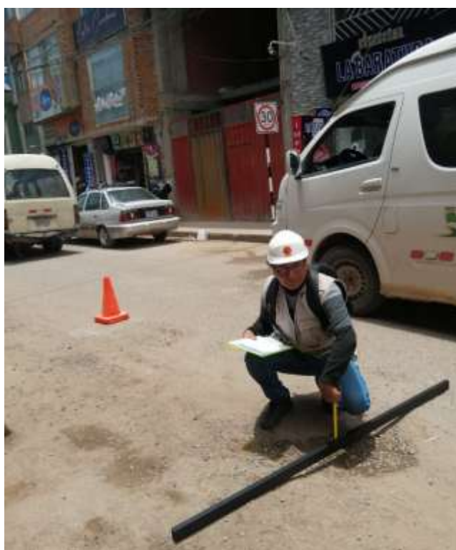
Fotografía 2. Tipo de falla hueco de severidad media en la progresiva 0+076 – 0+114.
