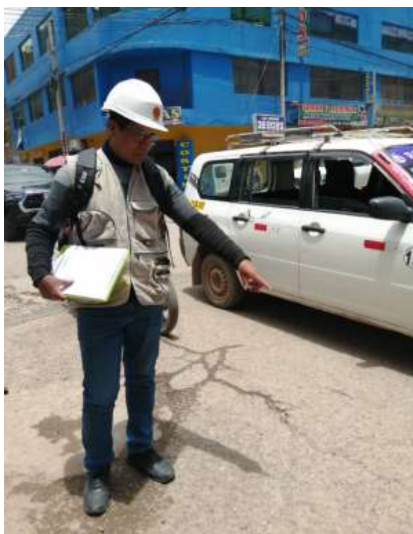
Fotografía 5. Tipo de falla grietas longitudinales y transversales.
