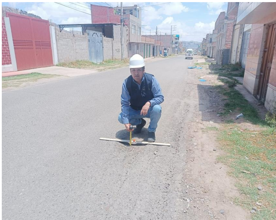
Fig. G.3 Falla depresión en la Av. Orgullo Aymara
