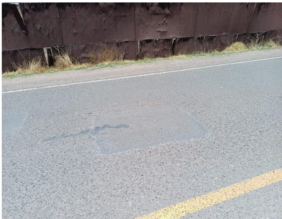
Fig. G.5 Falla parcheo en la Av. Orgullo Aymara
