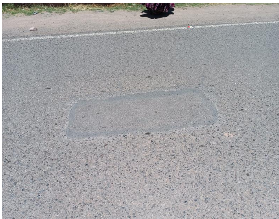
Fig. G.2 Falla Parcheo en la Av. Orgullo Aymara
