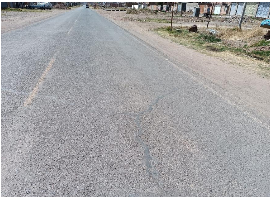
Fig. G.7 Falla grieta longitudinal y transversal en la Av. Orgullo Aymara
