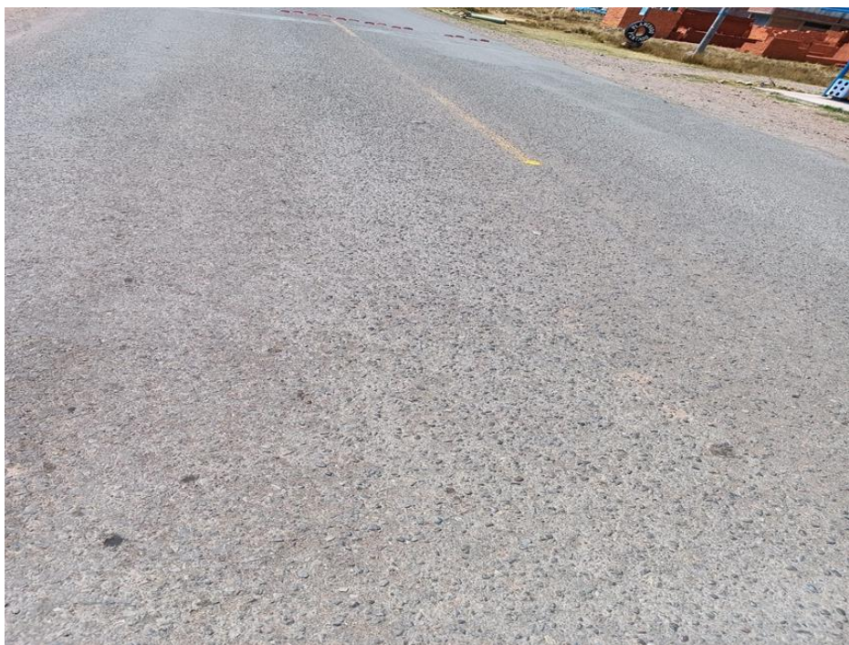
Fig. G.4 Falla pulimento de agregados en la Av. Orgullo Aymara
