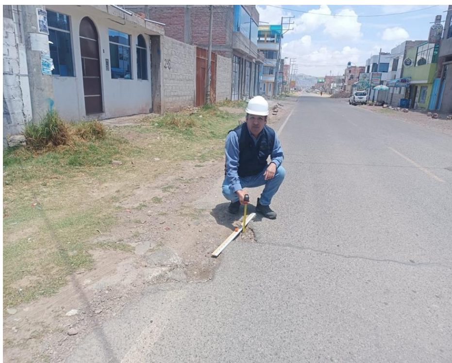
Fig. G.8 Falla Depresión en la Av. Orgullo Aymara
