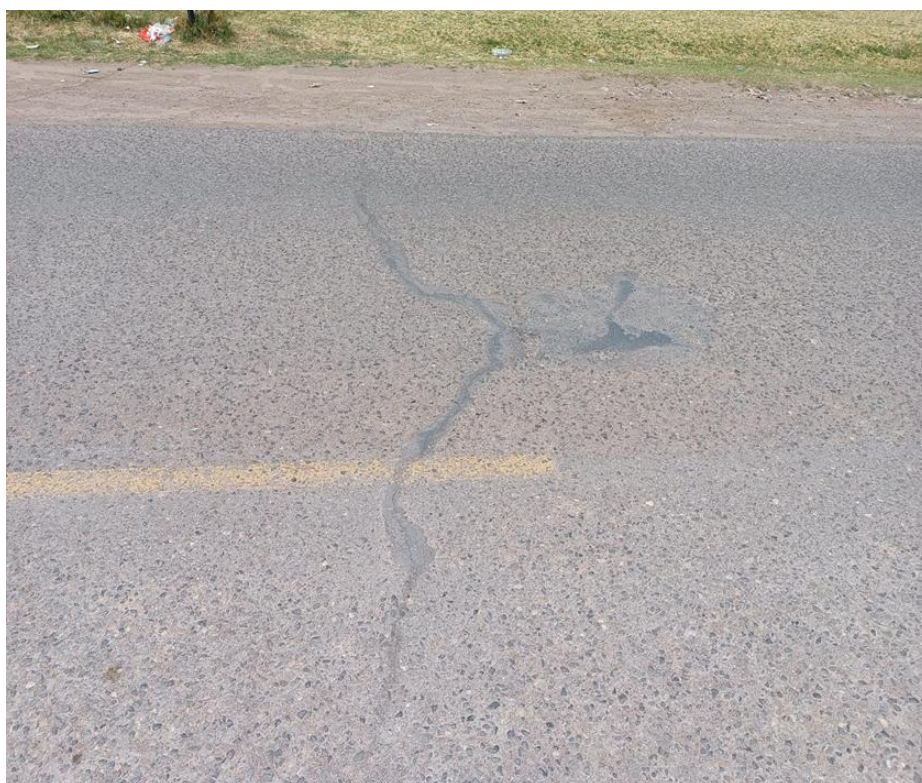
Fig. G.6 Falla grieta longitudinal y transversal en la Av. Orgullo Aymara
