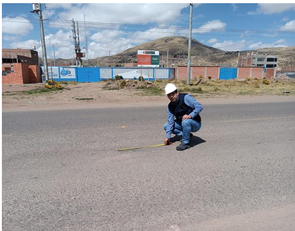
Fig. G.1 Medición de fallas en la Av. Orgullo Aymara
