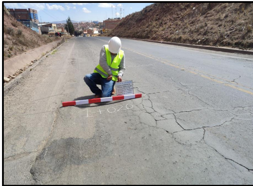
Figura 7: Ahuellamiento severidad Media según PCI
