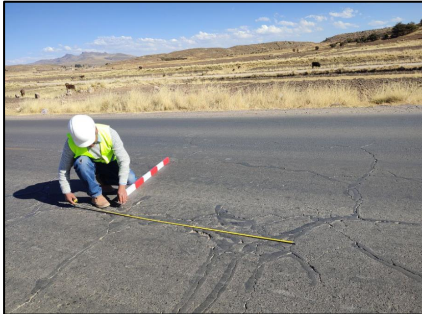
Figura 14: Falla longitudinal por fatiga nivel de gravedad 3 - VIZIR
