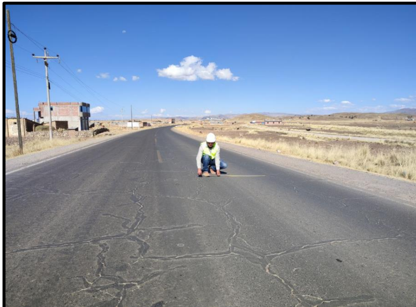
Figura 15: Fisura de piel de cocodrilo nivel de gravedad 2 - VIZIR
