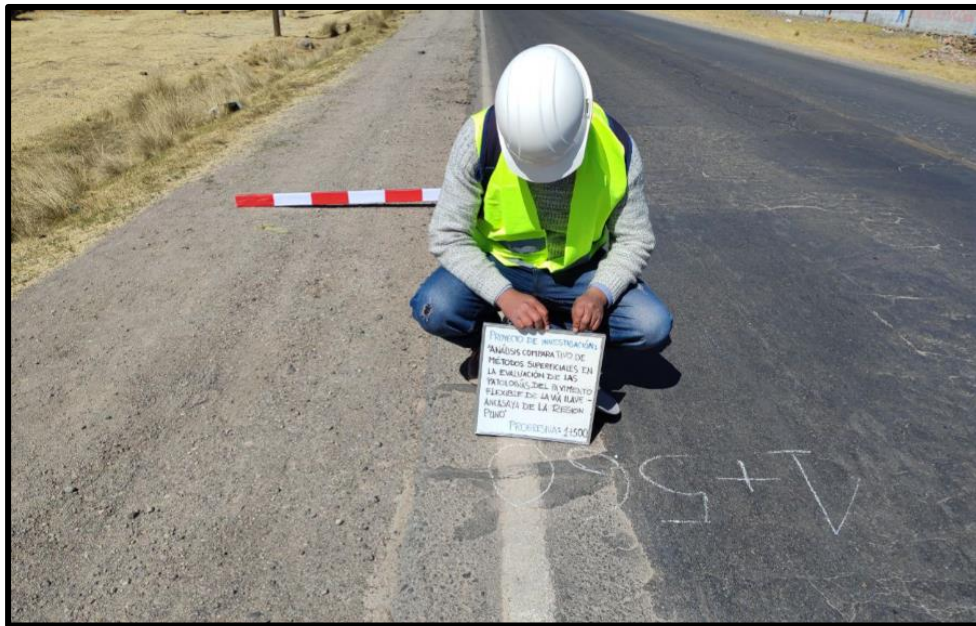
Figura 16: Bacheos y parches nivel de gravedad 3 - VIZIR
