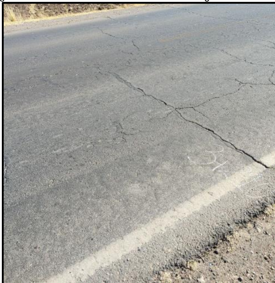
Figura 17: Fisura de contracción térmica nivel de gravedad 2 - VIZIR
