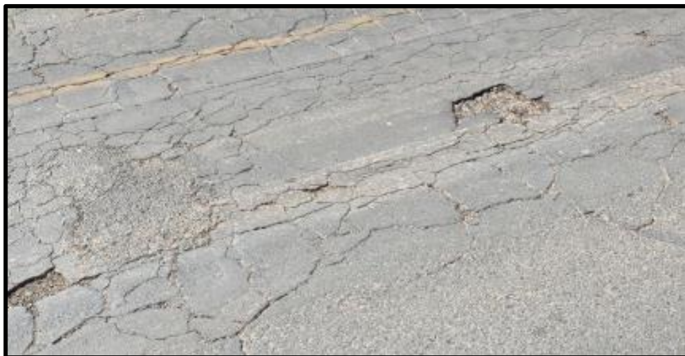
Figura 10: Huecos severidad alta según PCI
