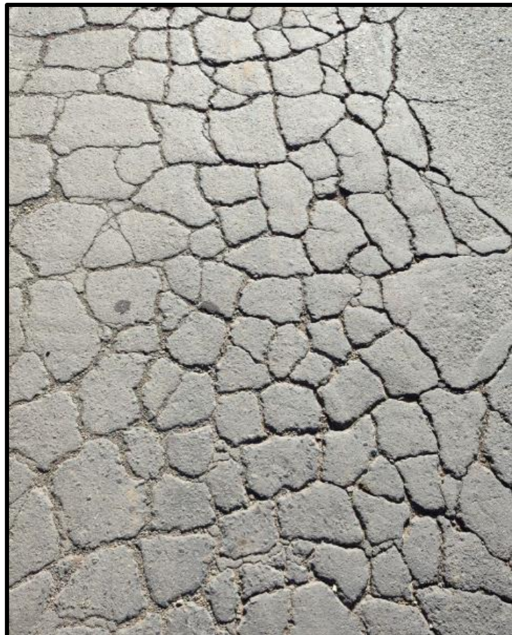
Figura 8: Desprendimiento de agregados severidad alta según PCI
