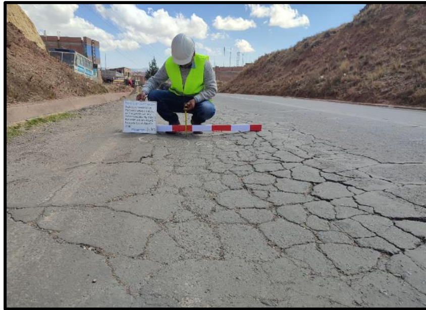
Figura 5: Falla agrietamiento en bloque severidad media - PCI
