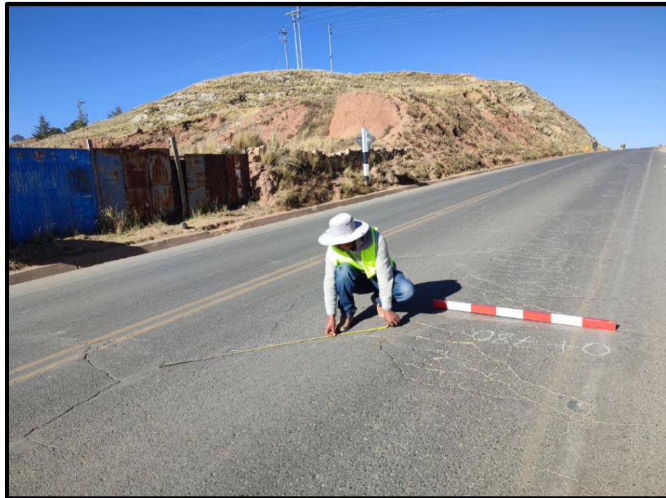
Figura 9: Pulimiento de agregados severidad alta según PCI
