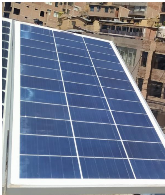
Figura 9 Panel solar fotovoltaico de 100 W, CIMESOLAR
