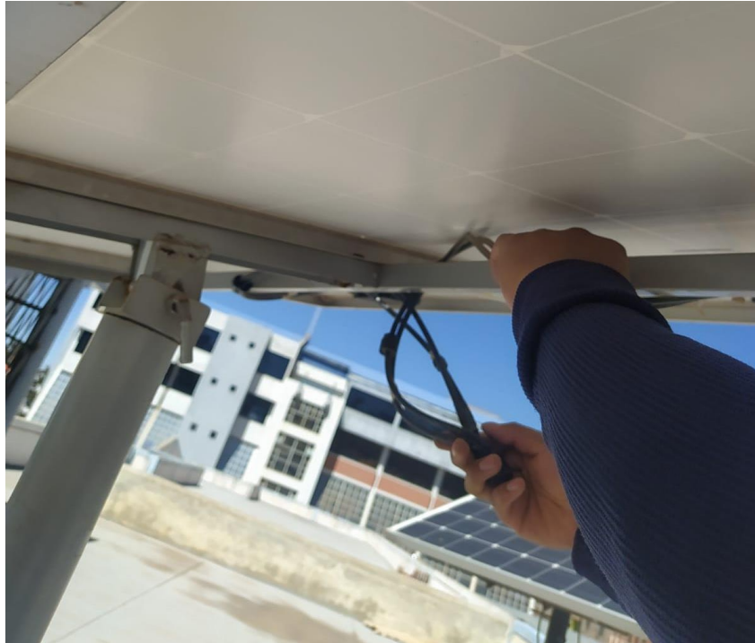
Cableado del módulo fotovoltaico.
