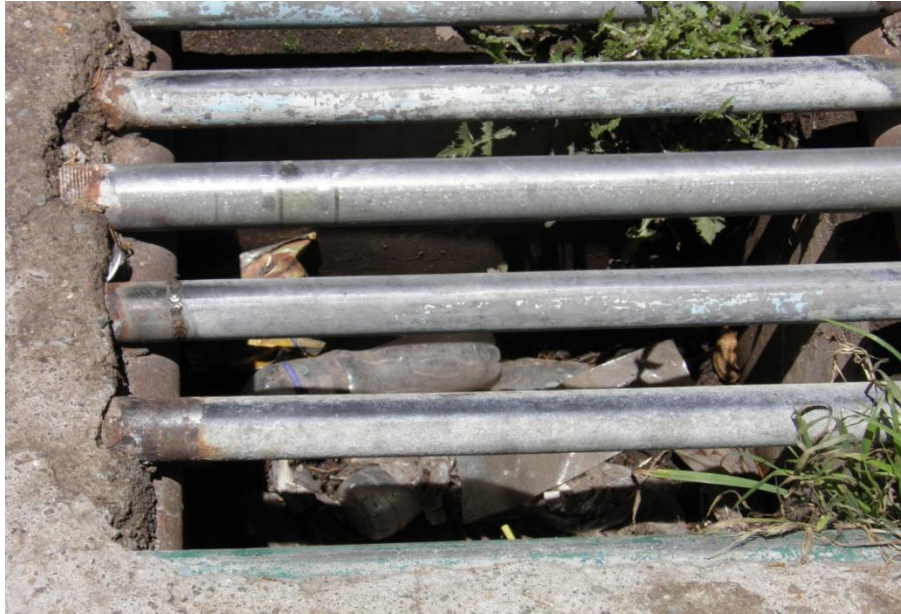
FOTOGRAFÍA 1: canal de aguas fluviales deterioradas
