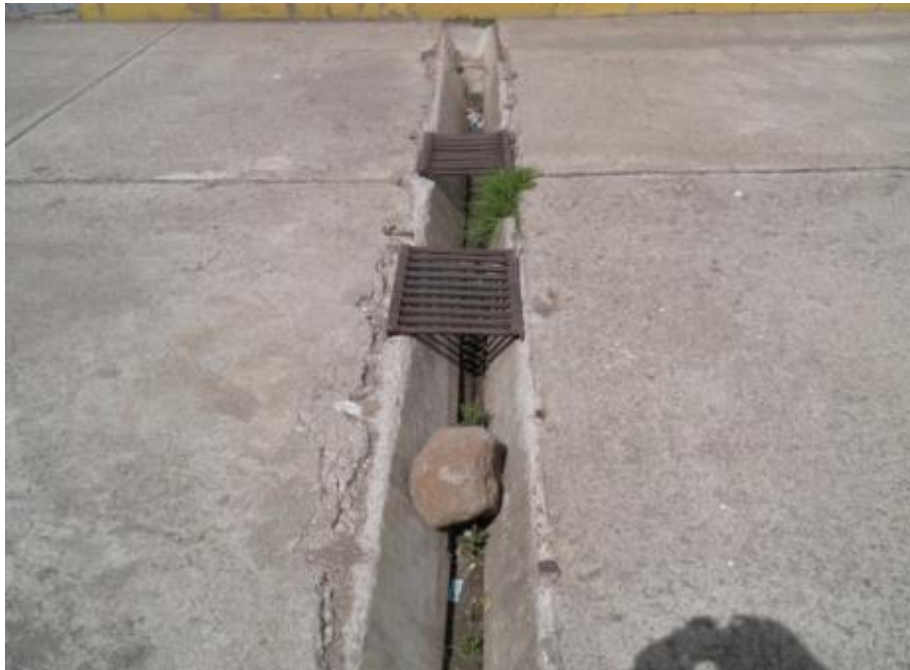
FOTOGRAFÍA 2: canales de agua fluvial oxidados
