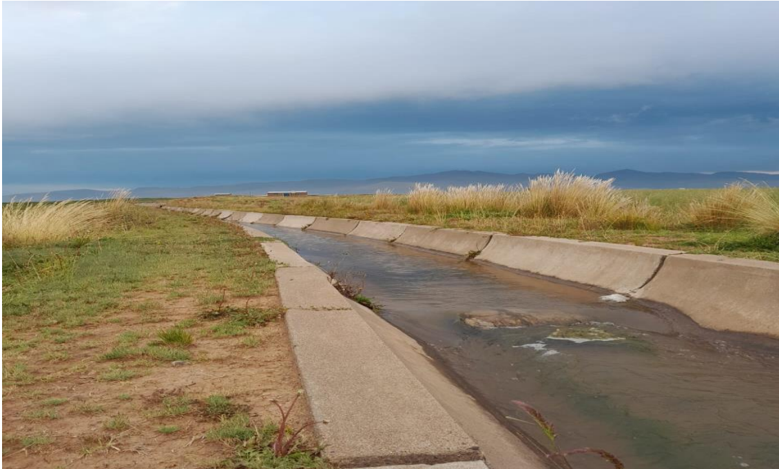
Figura 1. Ubicación de la canaleta para riego de vegetales y bebida de animales de la comunidad campesina San Juan Cullillaca, provincia de Lampa.
