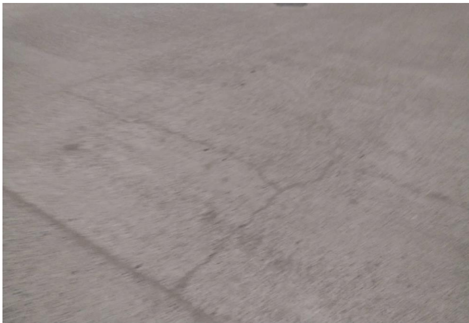
FOTO N° 07: fisura lineal y escala en paño
