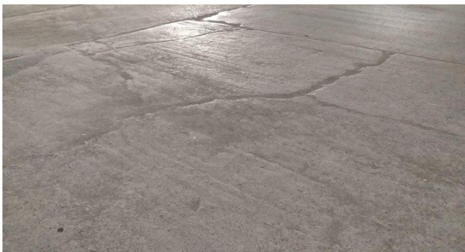
FOTO N° 10: Deterioro por Punzonamiento
