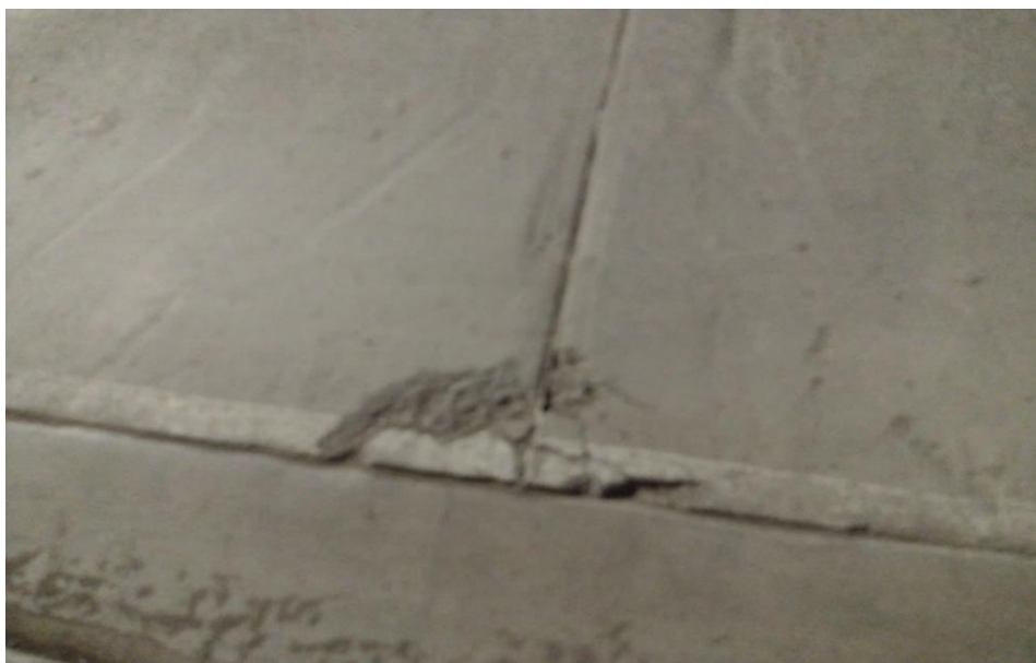
FOTO N° 02: Descascaramiento de Esquina
