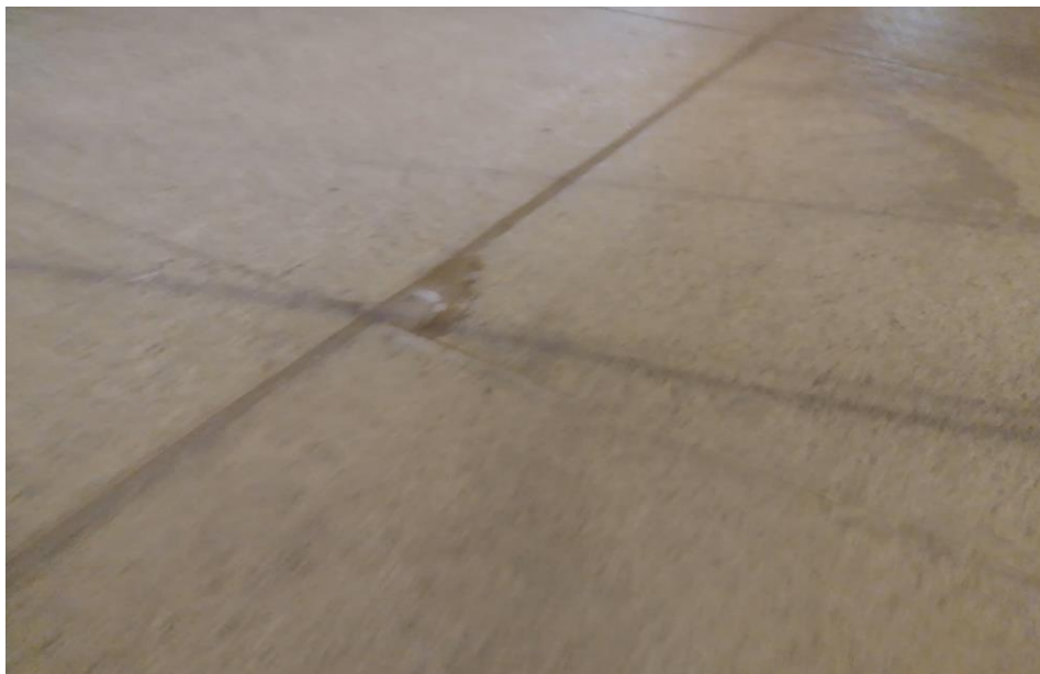
FOTO N° 05: Daño del sello de junta
