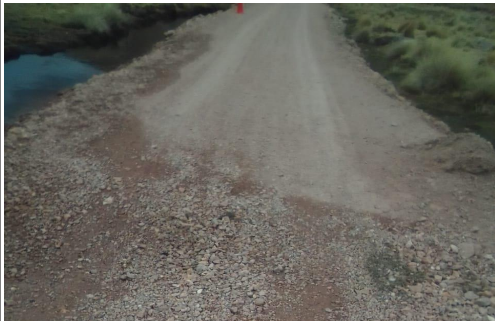
FOTO N° 07: Estado de calzada en un mal estado
