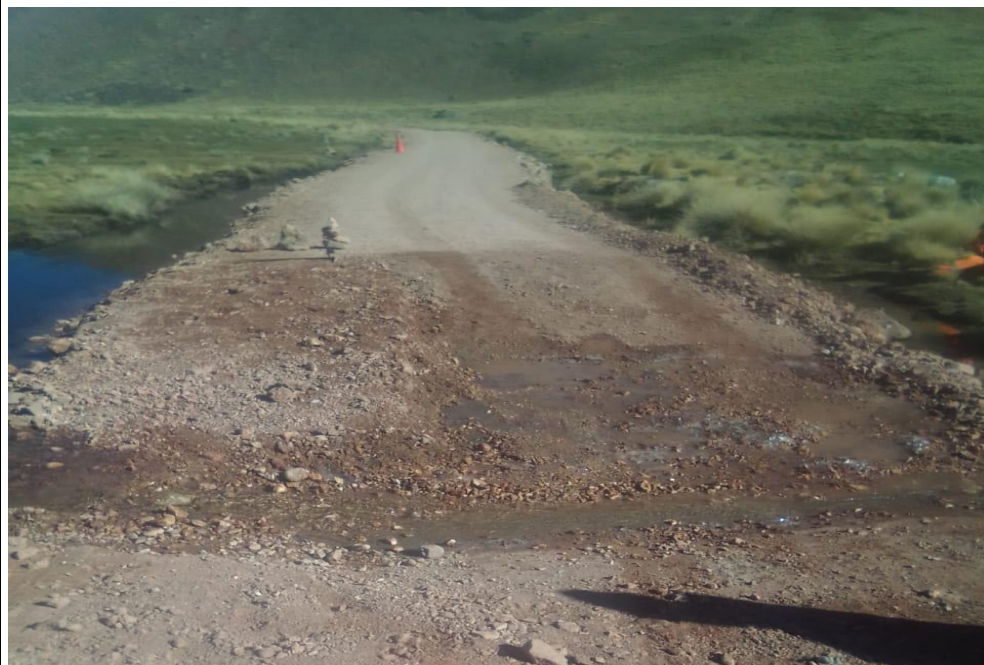
FOTO N° 09: Obras de drenaje están en condiciones críticas y requieren un mantenimiento urgente para evitar problemas mayores.
