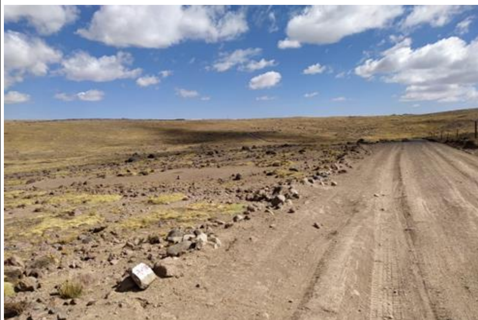
FOTO N° 02: Falta de mantenimiento en la calzada
