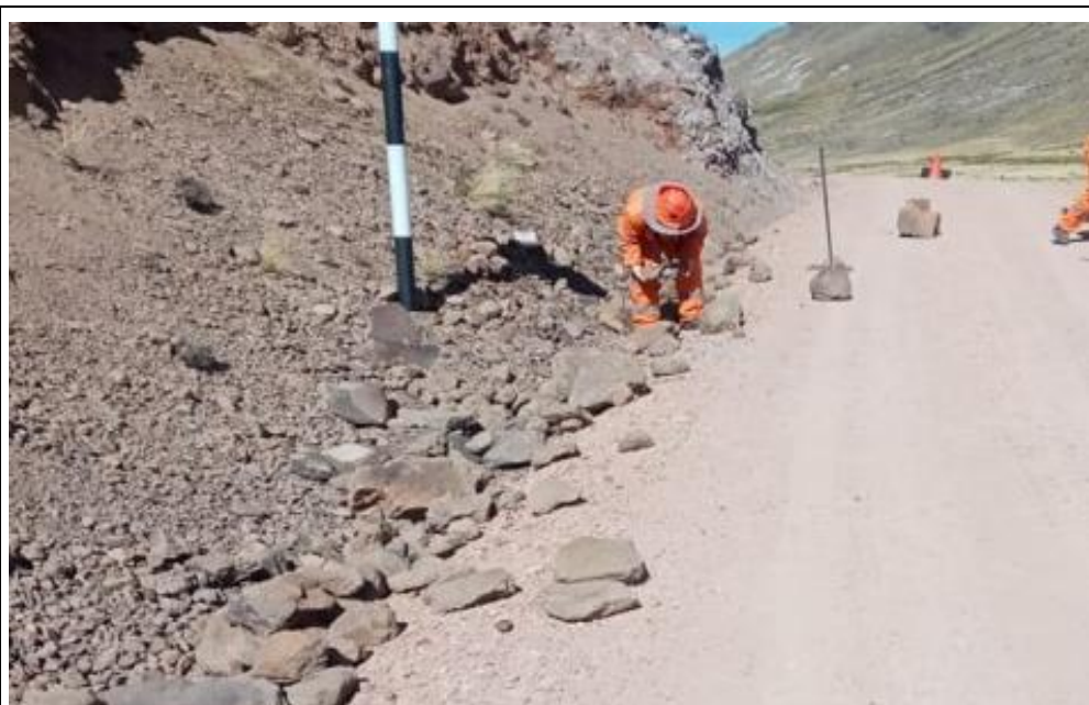
FOTO N° 03: Falta de mantenimiento en cunetas
