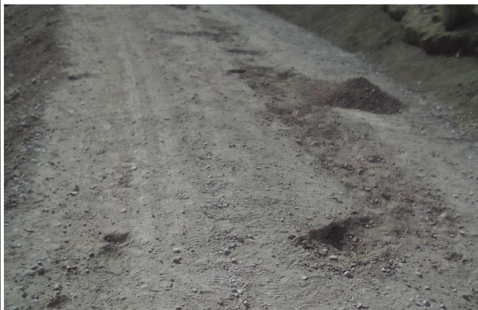
FOTO N° 11: La carretera en el tramo 6+600 requiere una reparación urgente debido a su deterioro significativo.
