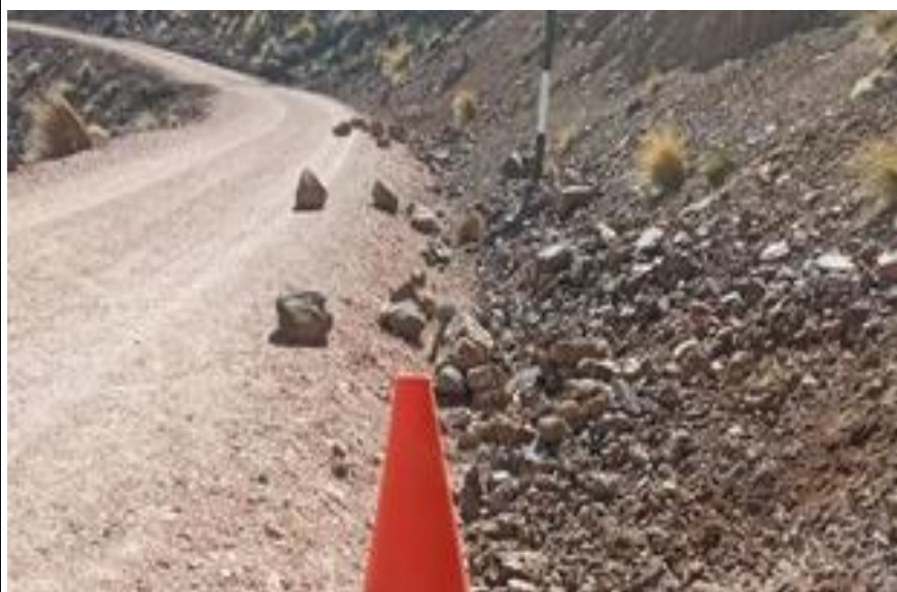
FOTO N° 06: Carencia de un mantenimiento en la calzada del camino vecinal
