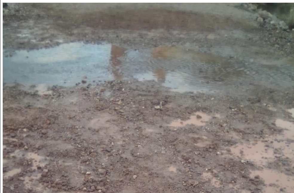
FOTO N° 10: Obras de drenaje están en condiciones críticas
