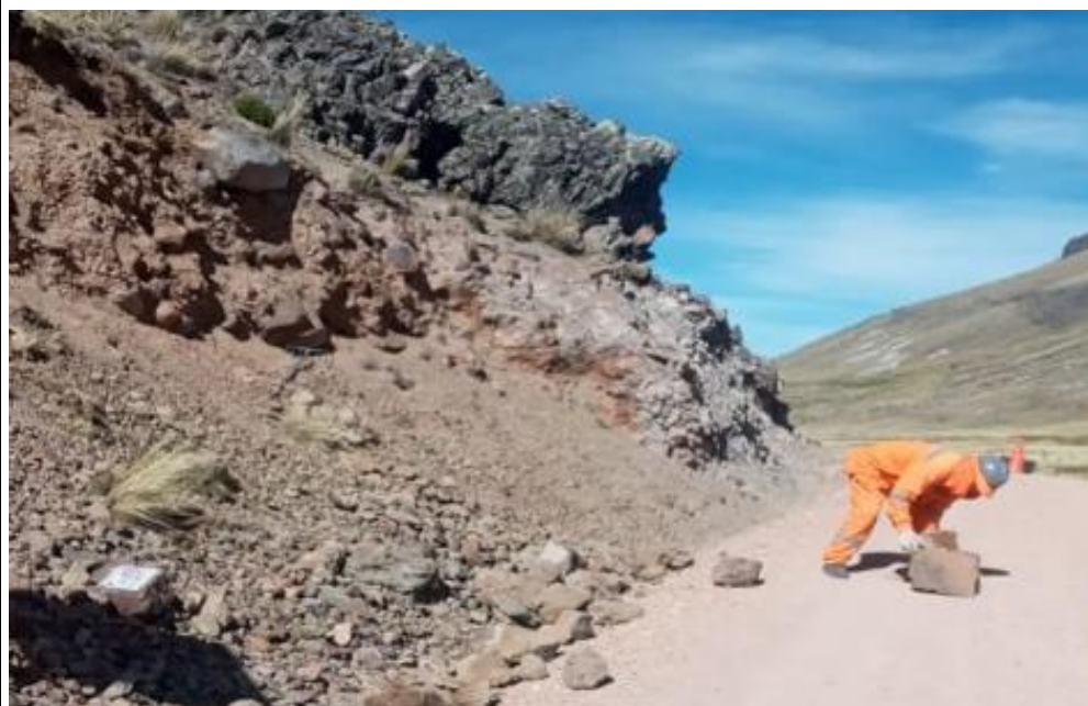
FOTO N° 04: Carencia de mantenimiento en cunetas y la colocación de señalizaciones en el camino vecinal
