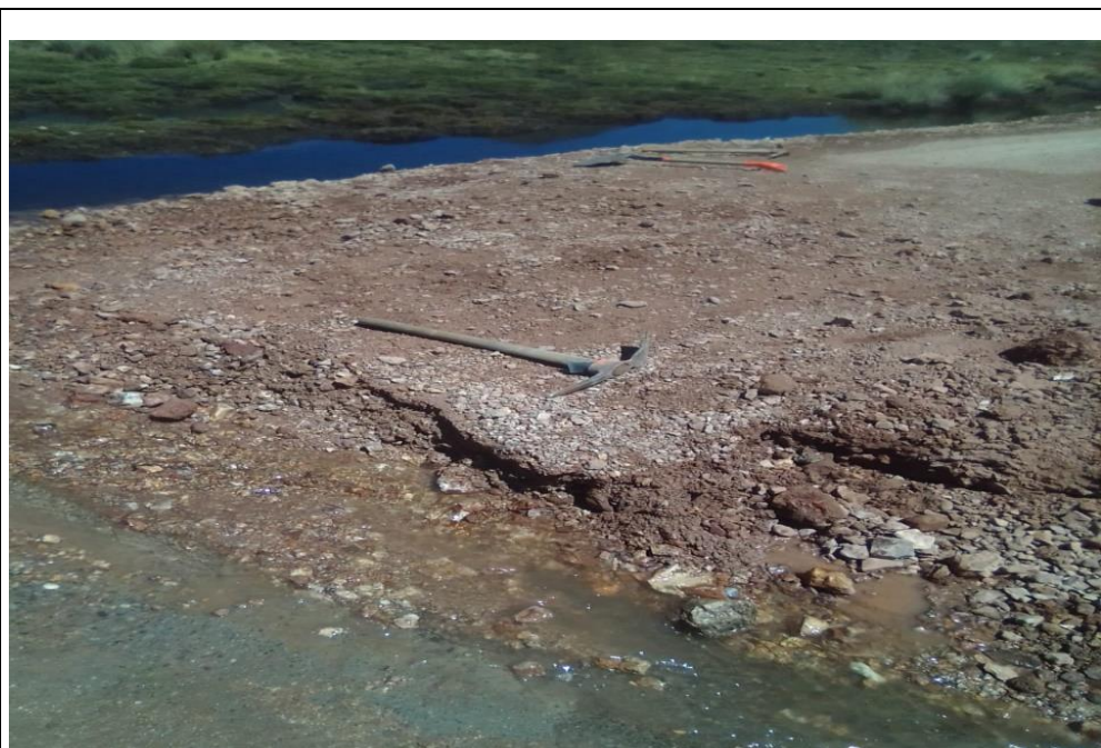
FOTO N° 05: La via se encuentra en un estado deficiente a falta de un mantenimiento rutinario
