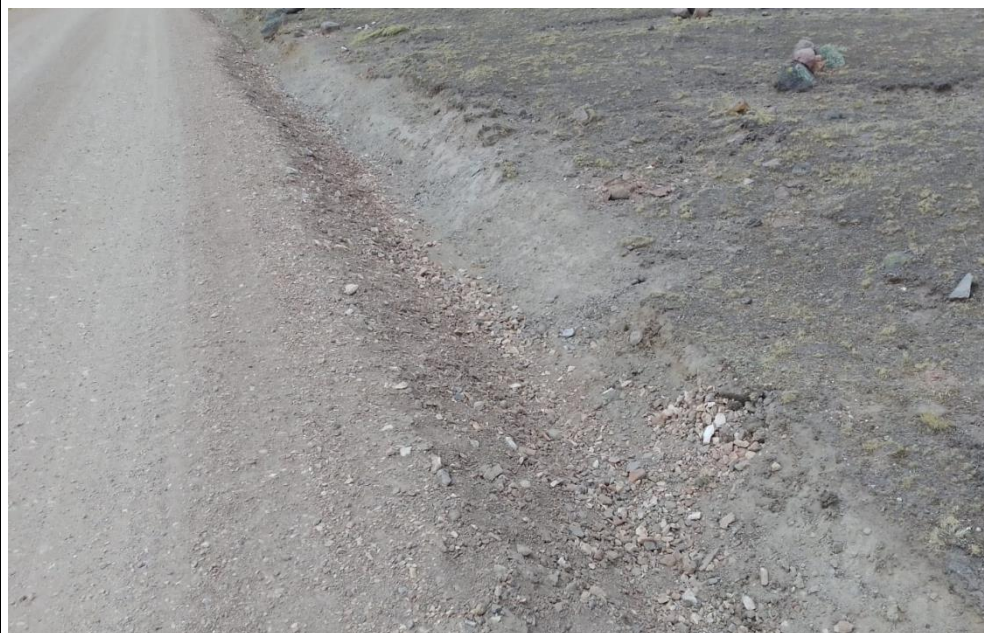
FOTO N° 13: Cunetas en un estado moderado o regular
