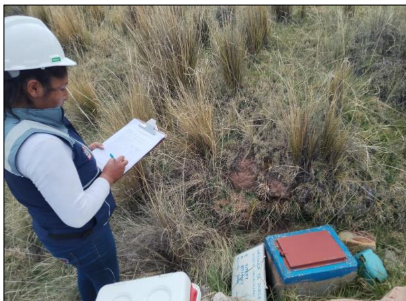
Fotografía 4. Inspección de la válvula del sistema de abastecimiento de Quinta Callacallani.
