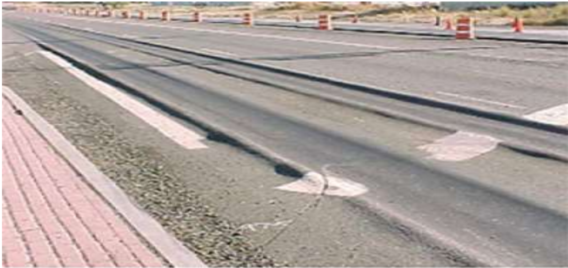
Pavimento con deformaciones plásticas
