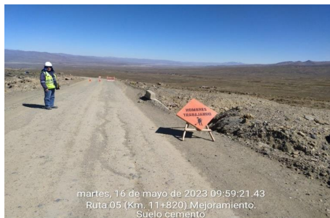
Fotografía 20. Señalización preventiva temporal en trabajos de mejoramiento
