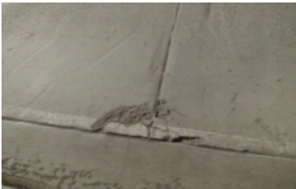
FOTO N° 02: Descascaramiento de Esquina
