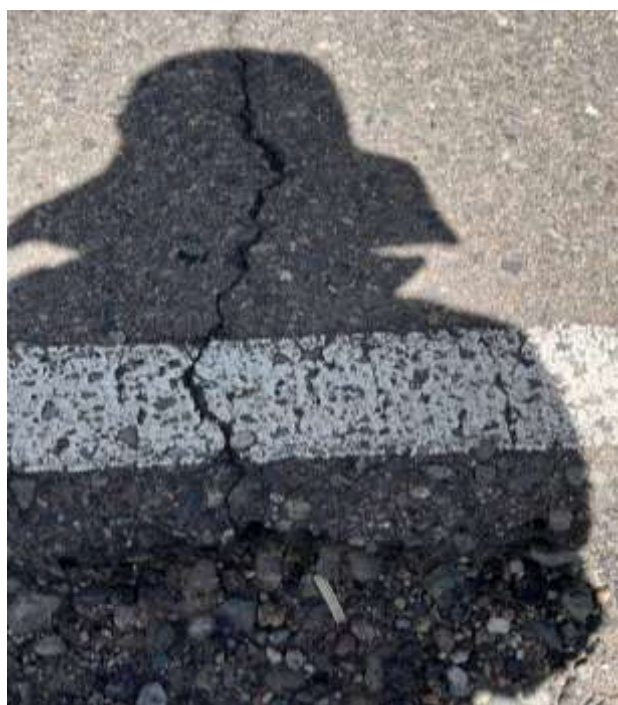
Fotografía 35. Falla grieta longitudinal
