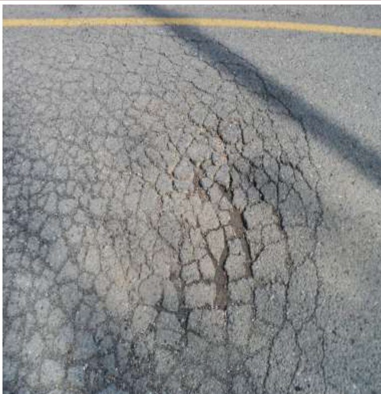
Fotografía 33. Falla – piel de cocodrilo
