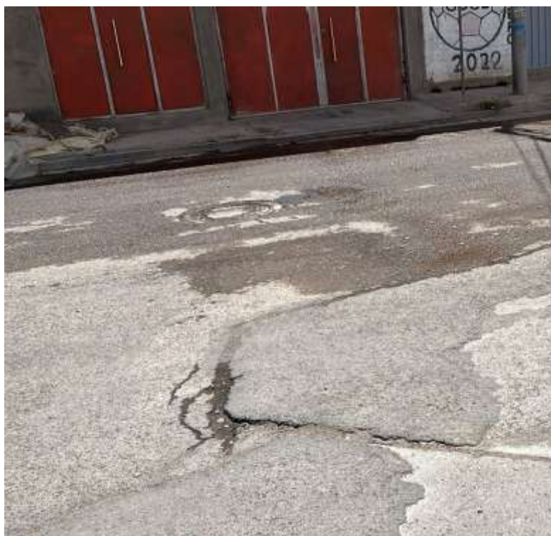
Fotografía 34. Falla – grieta de borde
