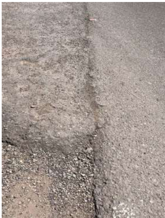
Fotografía 42. Falla desprendimiento de agregados
