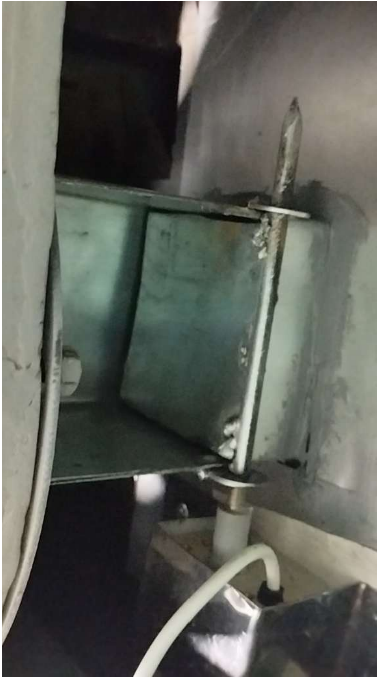
Fotografía 8. Vista de la válvula 04.
