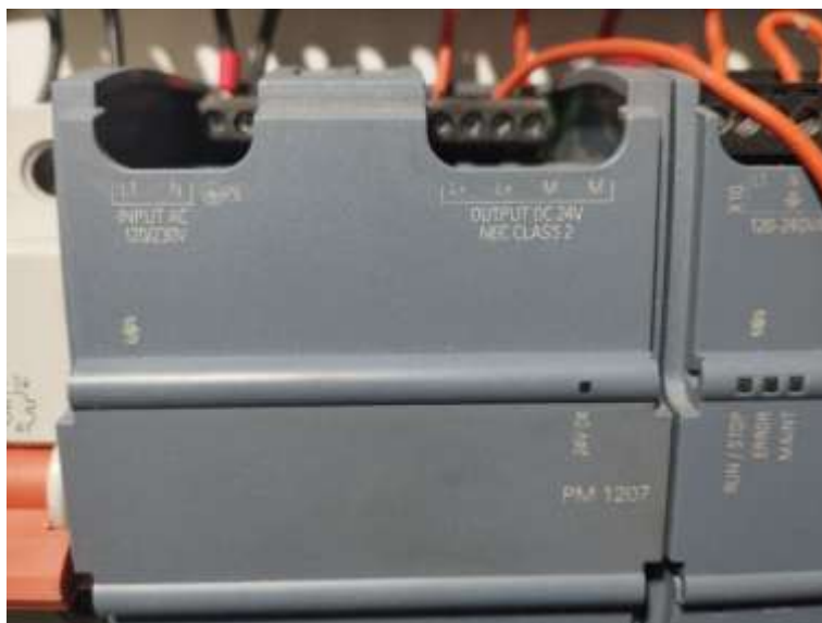
Fotografía 11. Vista de fuente de alimentación
