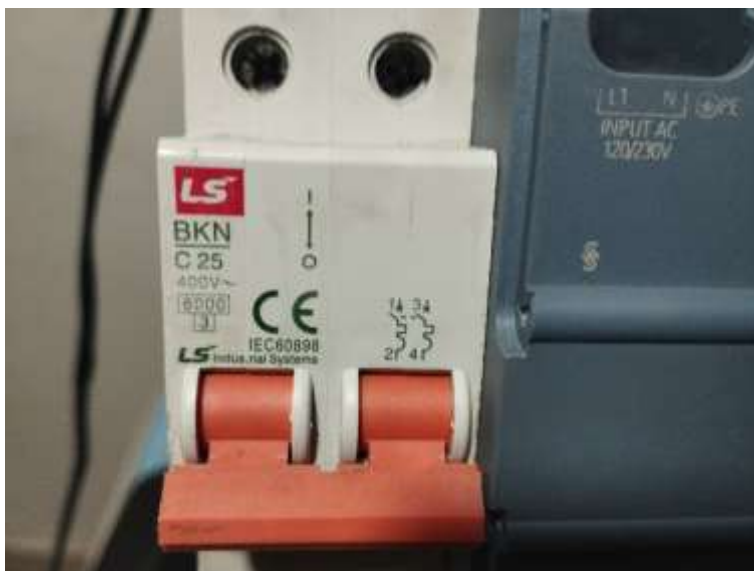
Fotografía 13. Vista del interruptor.
