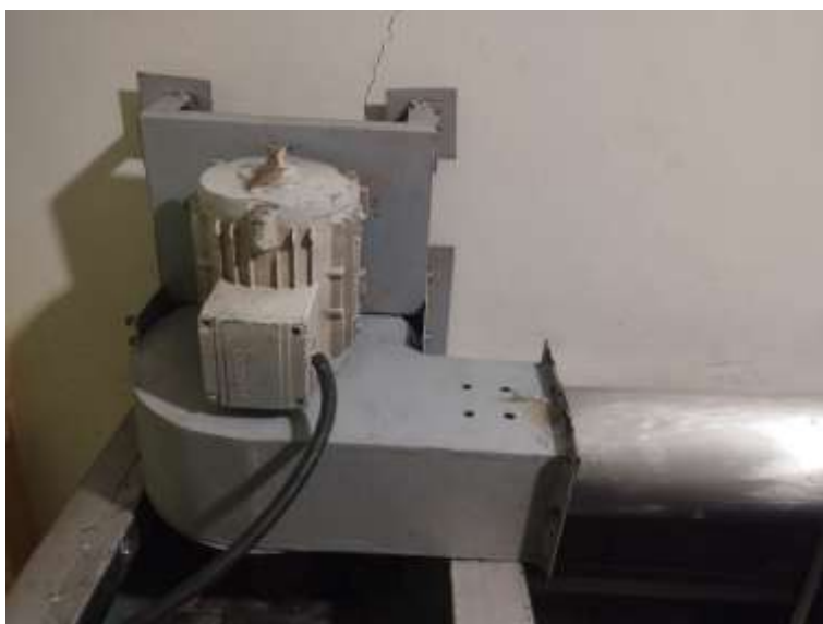
Fotografía 2. Vista del motor.
