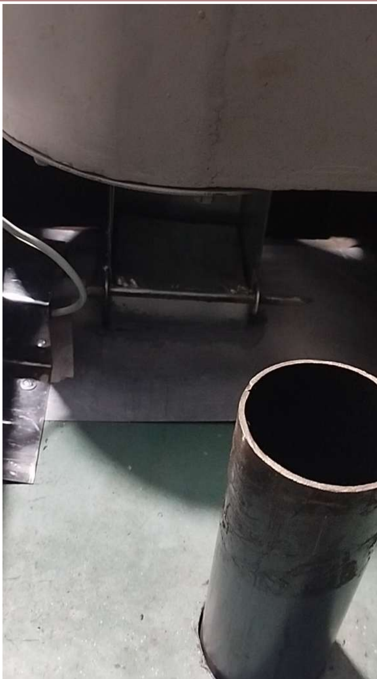
Fotografía 7. Vista de la válvula 03.
