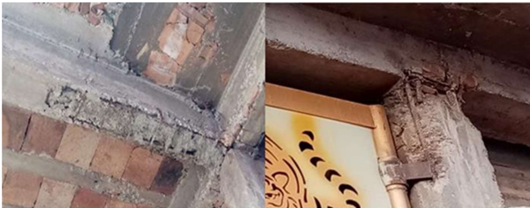
Acero corroído en viga
