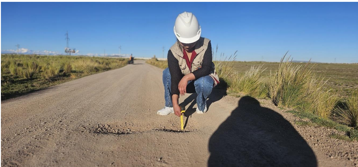
Fotografía 6. Daños encontrados en la vía.
