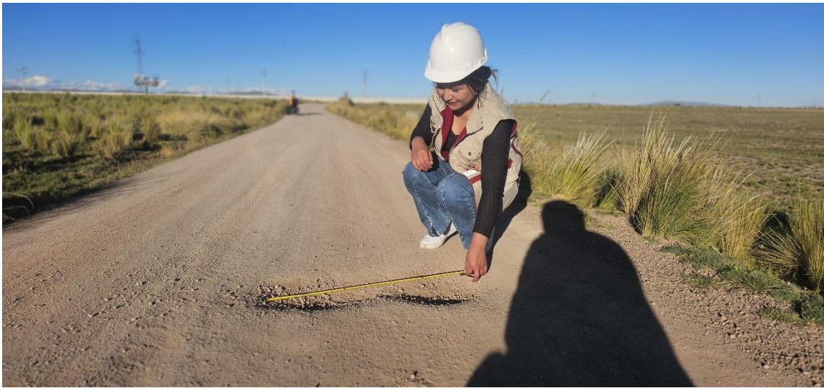
Fotografía 7. Daños encontrados en la vía.
