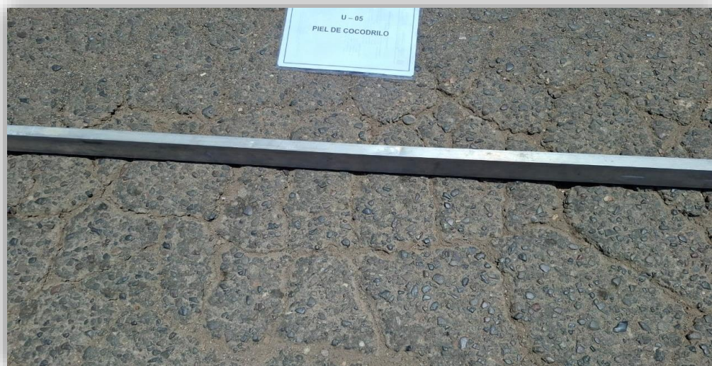
Figura 70: Falla tipo piel de cocodrilo representativa U-05.
