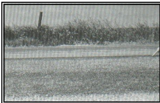
Figura 21: Simple: baja severidad.
