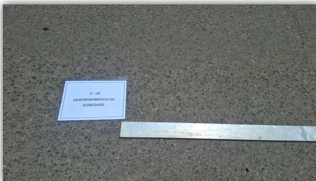
Figura 74: Falla tipo desprendimiento de agregado representativa U-09.
