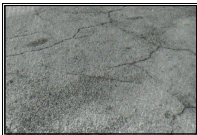
Figura 16: Grietas severidad media.
