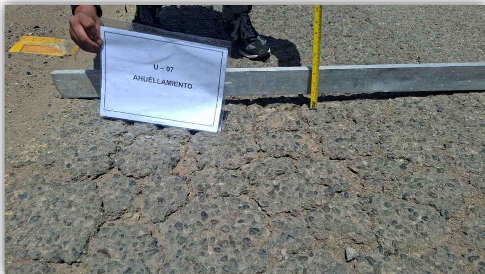
Figura 72: Falla tipo Ahuellamiento representativa U-07.
