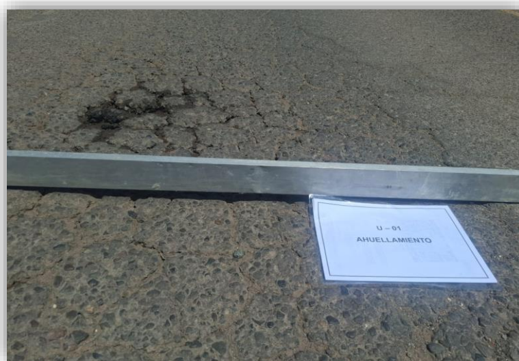
Figura 66: Falla tipo Ahuellamiento representativa U-01.
