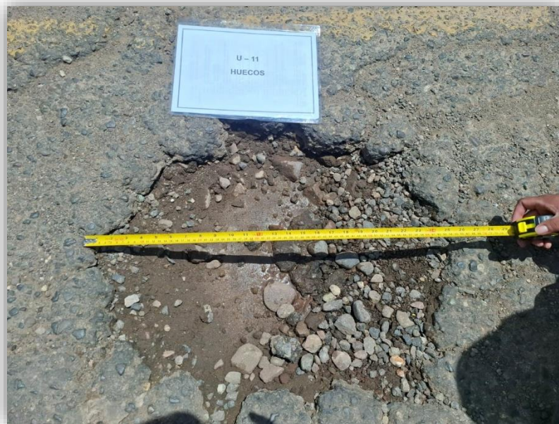
Figura 76: Falla tipo Huecos U-11.
