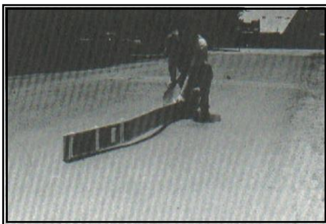
Figura 51: Desplazamiento: severidad baja
