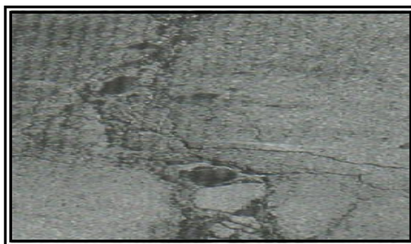
Figura 38: Grietas longitudinal alta severidad.
