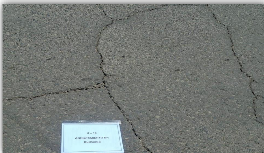
Figura 75: Falla tipo Agrietamiento en Bloques representativa U-10.
