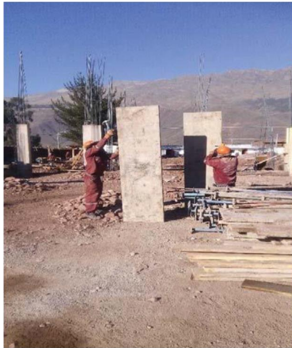
Todas las columnas se encuentran desenconfradas
