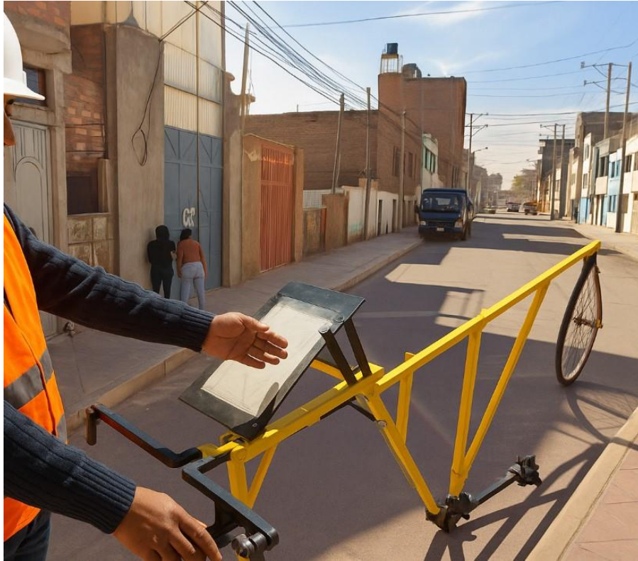
IMAGEN 03 – REVISION DE ELEVACIÓN Y DEPRECIACIÓN DE VIA
