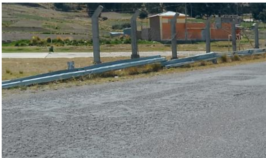
Señalización Vertical en mal estado
