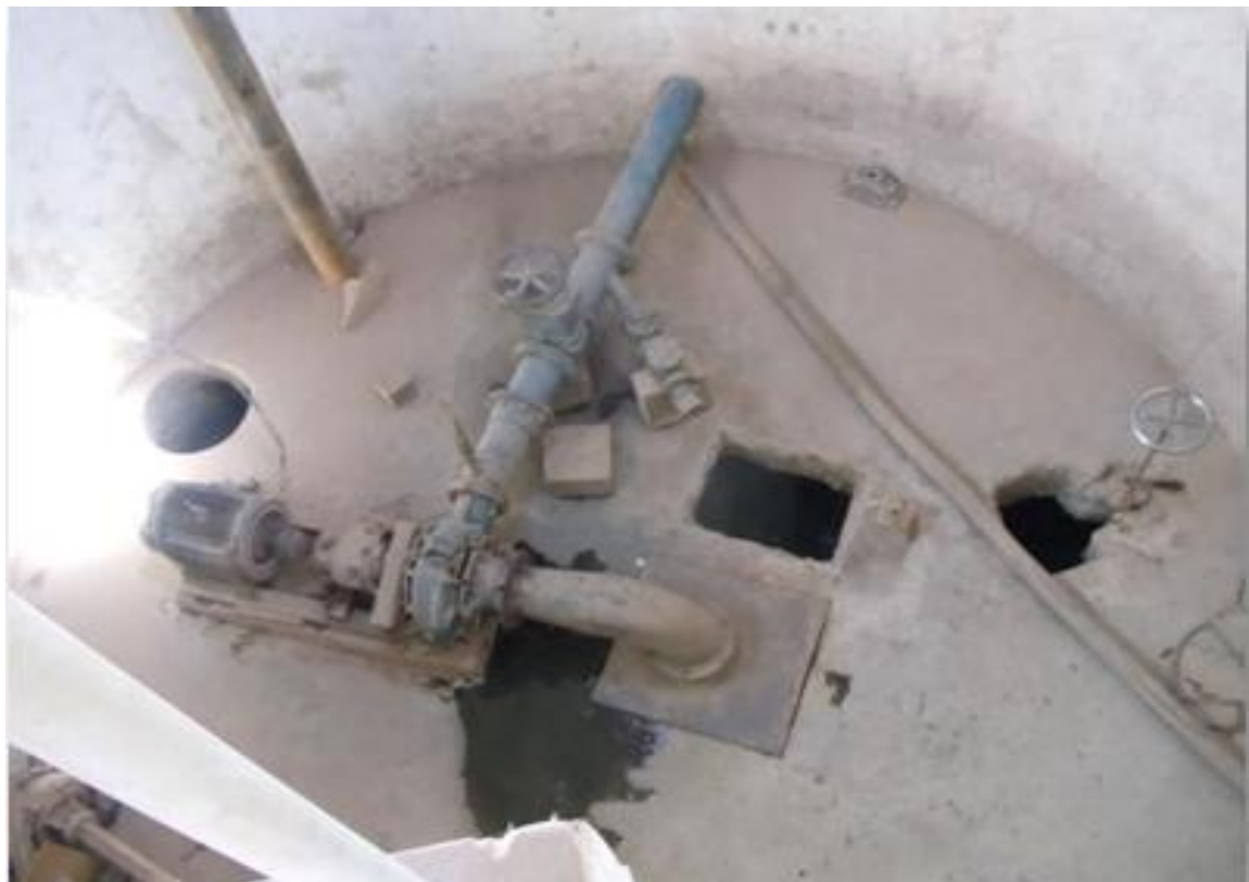
Fotografía 4: El Deficiente Funcionamiento de la Cámara de Bombeo - CAPILLA
