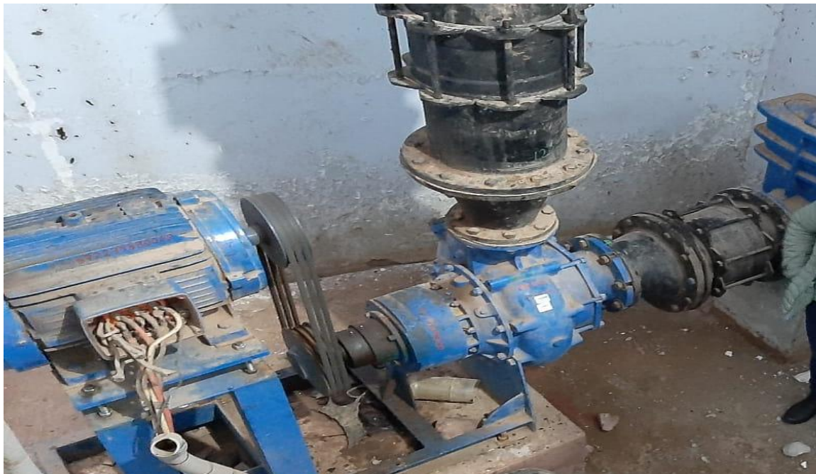
Fotografía 3: Bomba en mal estado - TAMBOPATA
