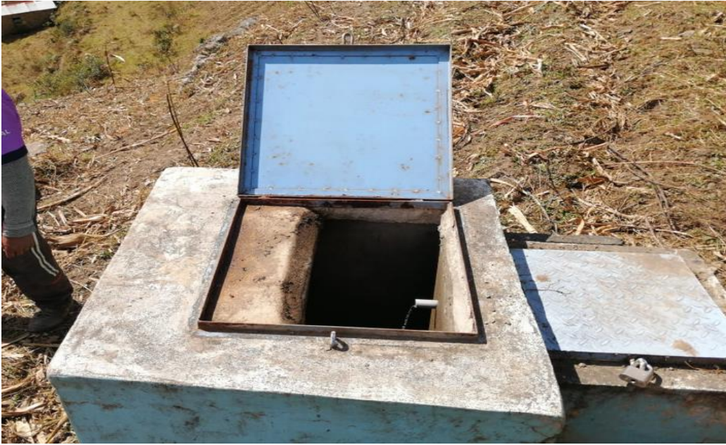
Fotografía 4: Cámara Rompe Presión T 07
