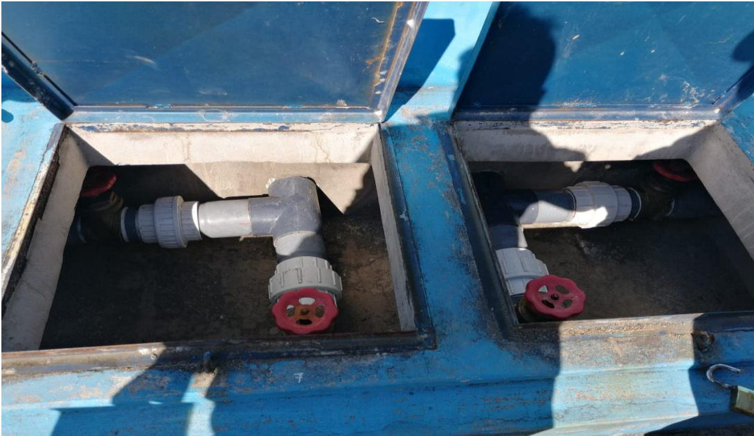
Fotografía 1: caja de valvulas
