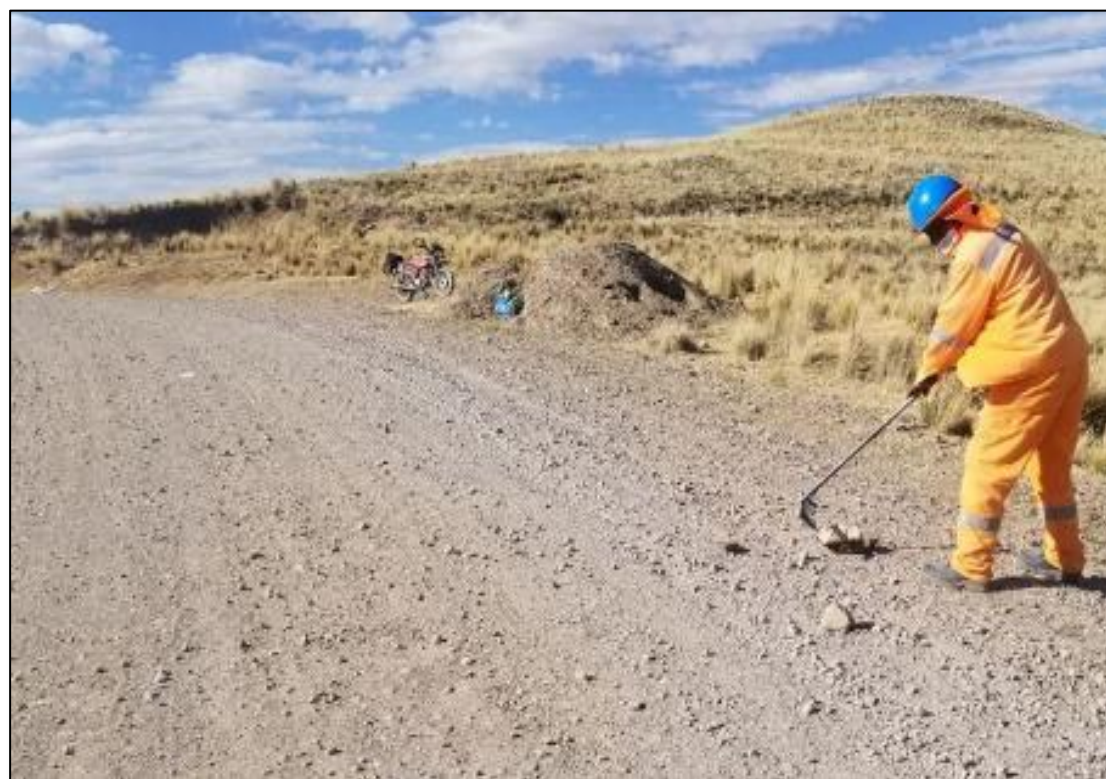
Fotografía 22. La fotografía muestra un deterioro de ahuellamiento mayor a 10 cm
