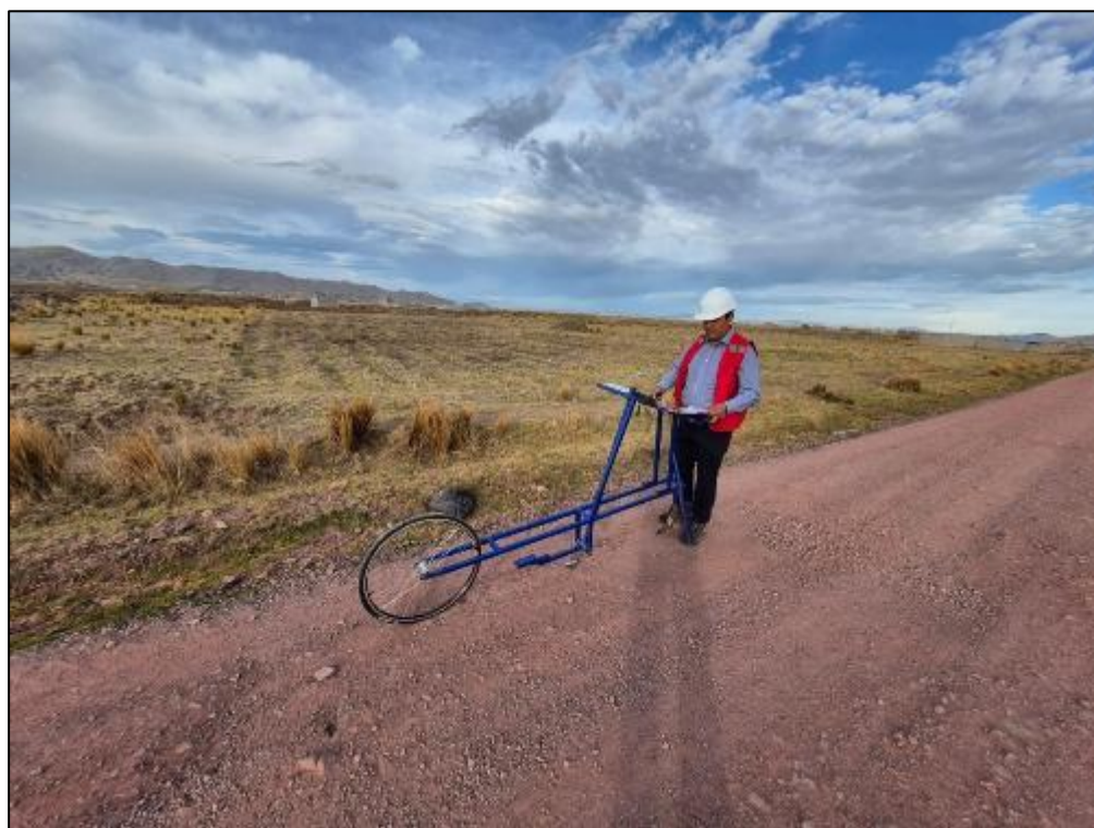
Fotografía 4. Deformaciones sobre la superficie de la vía.
