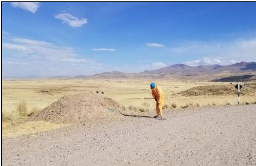
Fotografía 23. La fotografía muestra un deterioro de ahuellamiento mayor a 5 cm
