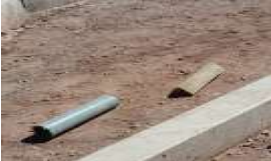
Fotografía 7. Desechoss encontrados (restos de tubo PVC) en la etapa constructiva de obras minimas (pista de un tramo) en el distrito de Juliaca.
