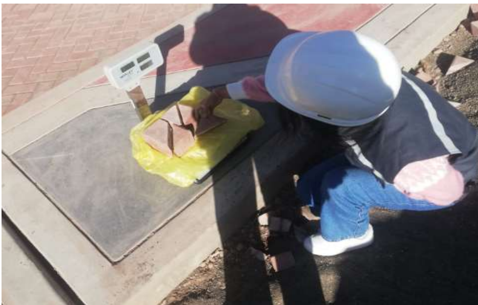
Fotografía 8. Pesaje de desechoss (escombros de ladrillo) en la etapa constructiva de obras minimas (pista de un tramo) en el distrito de Juliaca.
