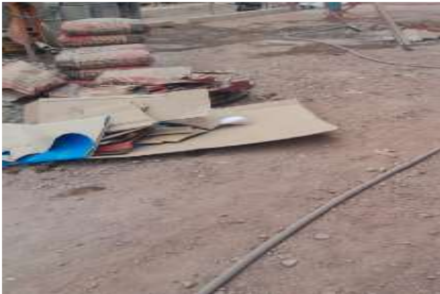
Fotografía 6. Desechos encontrados (cartón) en la etapa constructiva de obras minimas (pista de un tramo) en el distrito de Juliaca.
