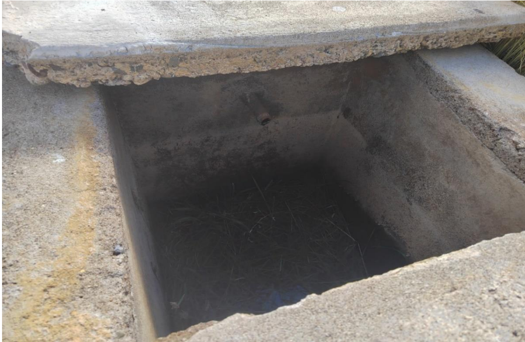
Figura 7. Visualización del deterioro y abandono de componentes adyacentes del sector Suma Pujo.
