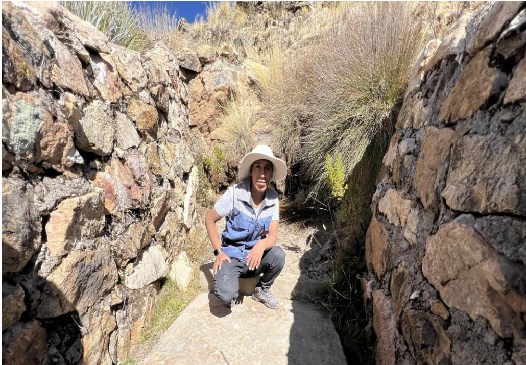
Figura 5. Observación de la cámara de captación de agua para la distribución como agua potable para sector Suma Pujo.
