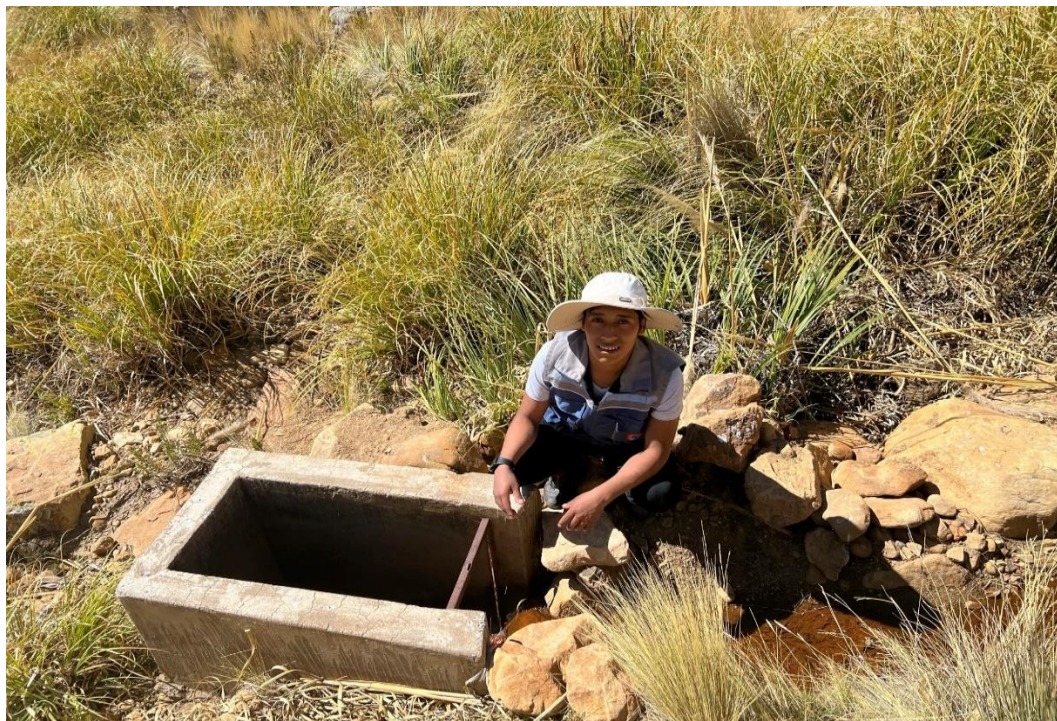
Figura 8. Observación del estado de deterioro y abandono de componentes adyacentes del sector Suma Pujo.
