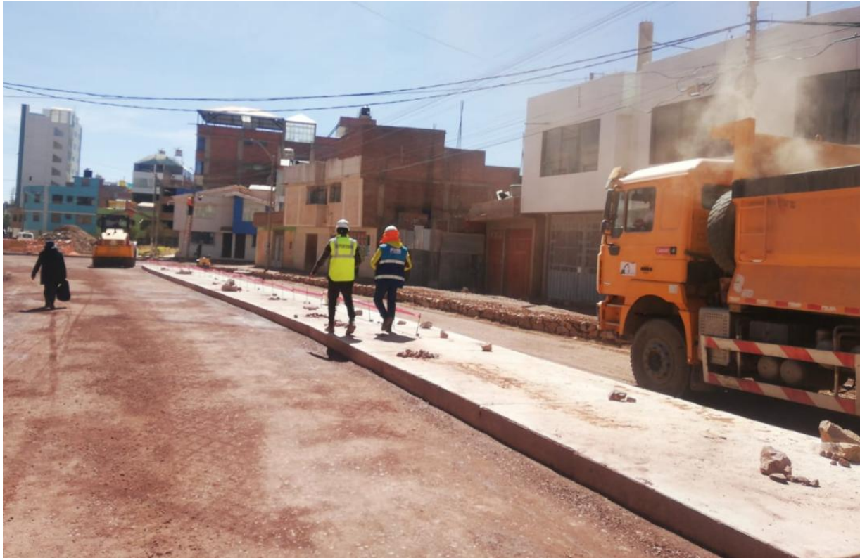
Fotografía 3: Contaminación de ruido y aire por presencia de maquinarias
