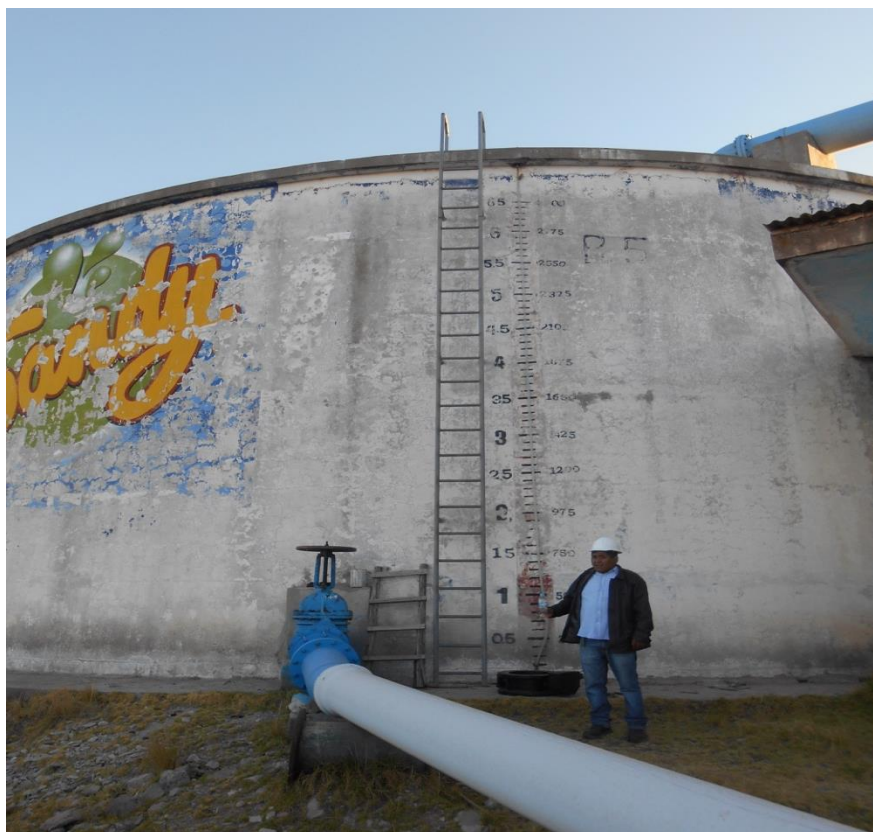
RESERVORIO APOYADO RA-05 – 3000 M3
