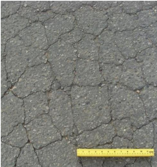
FOTO 13, 14 y 15: Se observa agregado pulido de baja severidad, exudación y piel de cocodrilo
