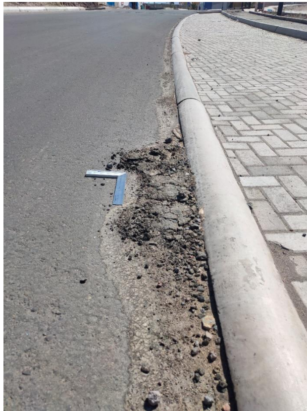
FOTO 9 y 10: Se observa exudación de de baja severidad y un levantamiento del pavimento de media severidad
