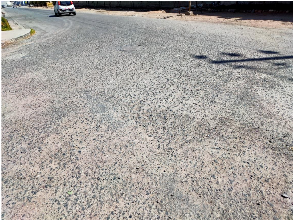
FOTO 5 y 6: Se observa la fisuras en bloque de alta severidad, pulimiento de agregados de alta severidad y ahuellamiento
