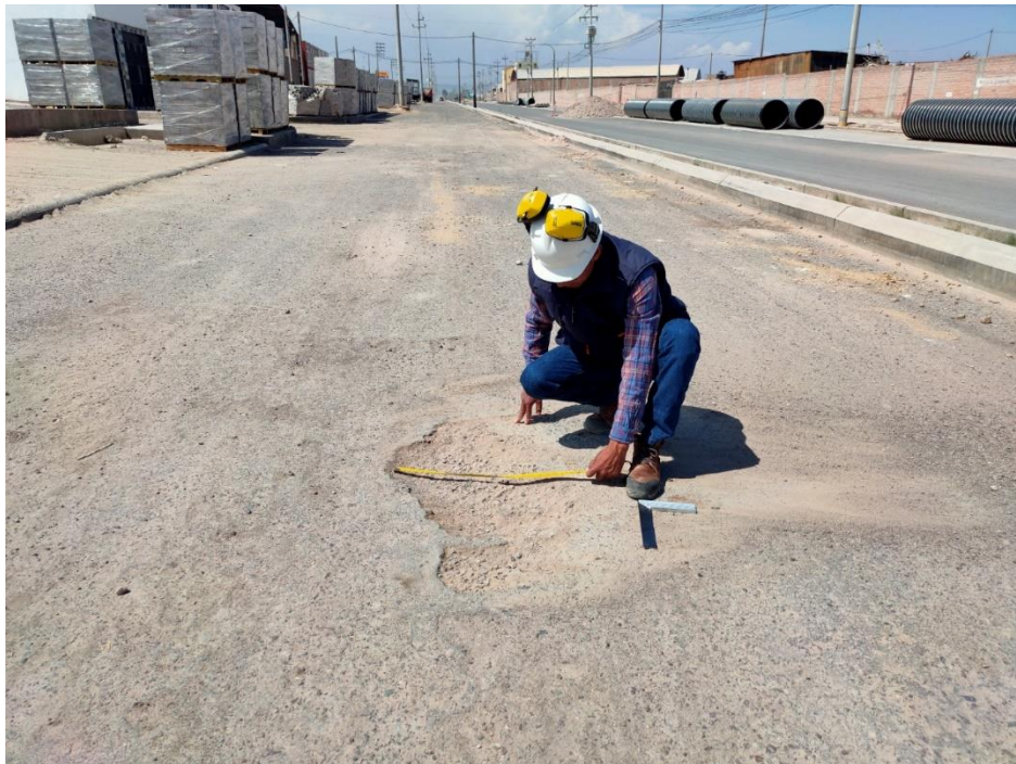
FOTO 7 y 8: Se observa una fisura de borde de baja severidad y un bache de alta severidad.
