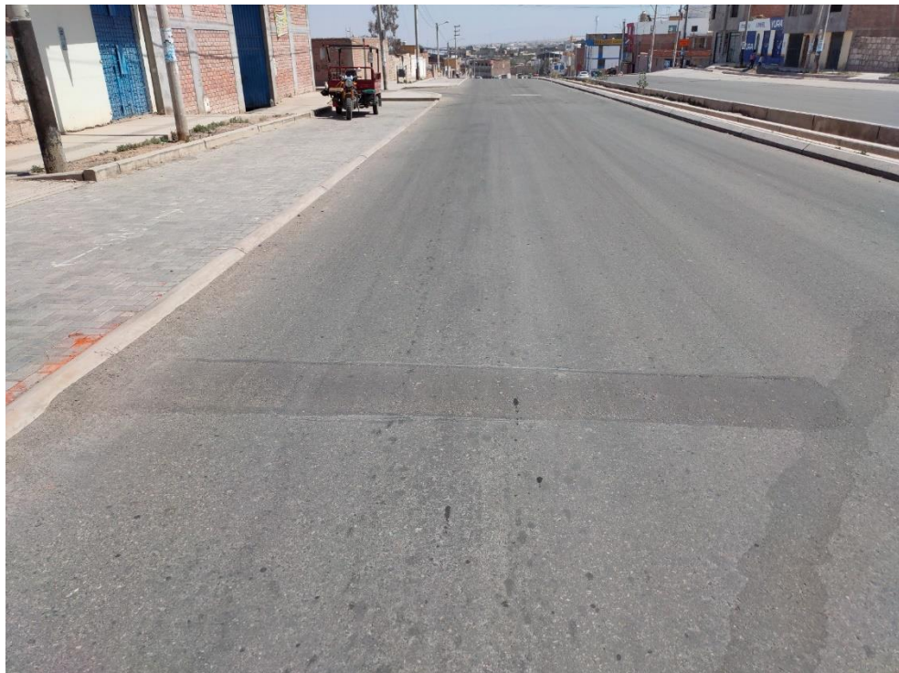
FOTO 11 y 12: Se observan fallas de tipo parcheo y exudación de baja severidad
