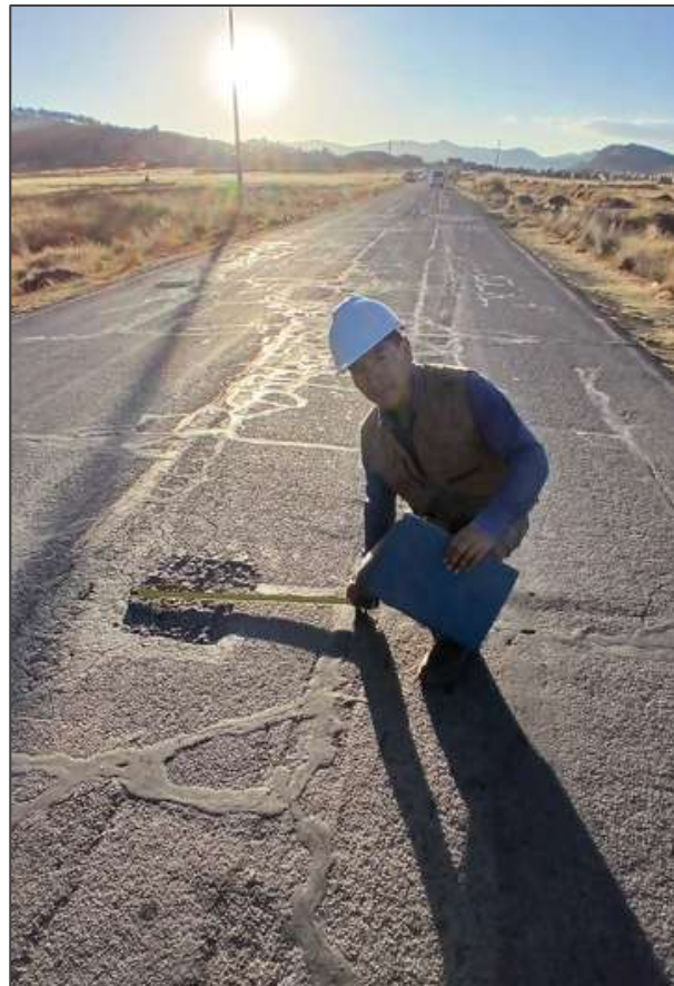
Fotografía N° 02: Verificación de existencia de tipo de falla hueco
