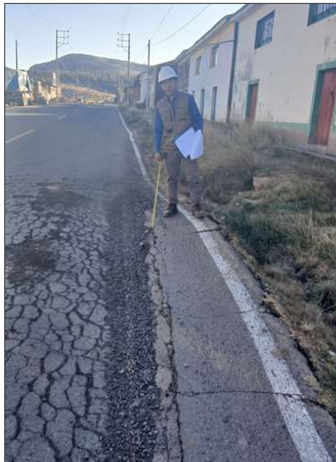
Fotografía N° 22: Tipo de falla piel de cocodrilo y desplazamiento en severidad alta
