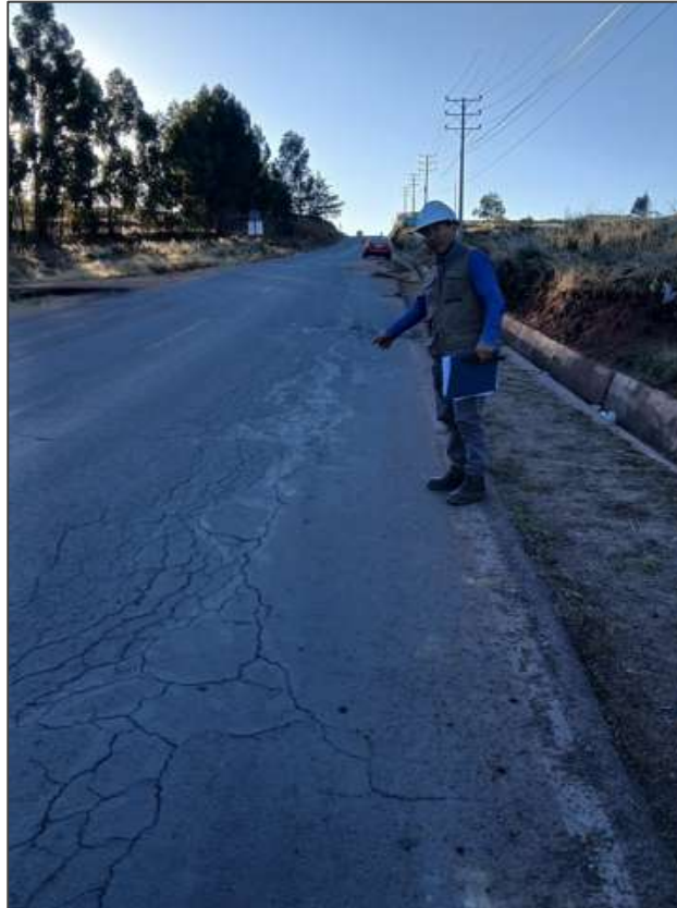
Fotografía N° 05: Tipo de falla piel de cocodrilo en severidad alta
