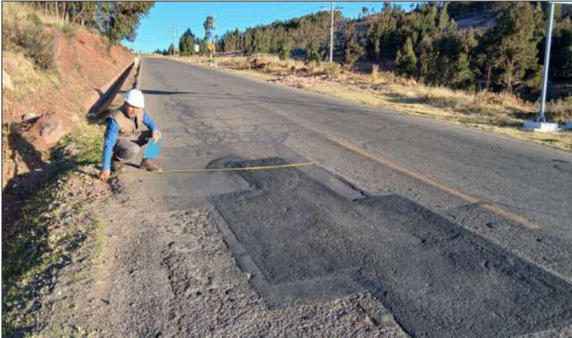
Fotografía N° 21: Medición de falla parcheo en severidad alta
