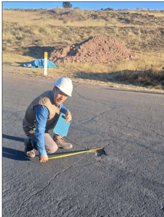
Fotografía N° 08: Tipo de falla hueco y fisuras transversales en severidad media
