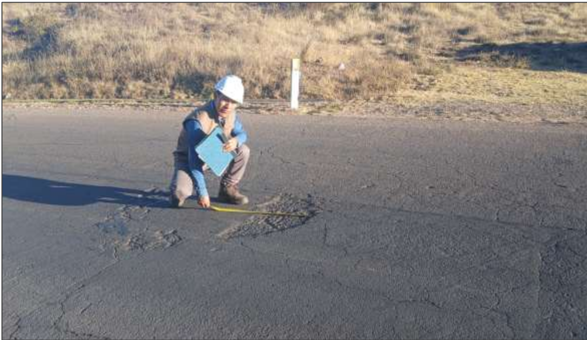
Fotografía N° 09: Tipo de falla desprendimiento de agregados
