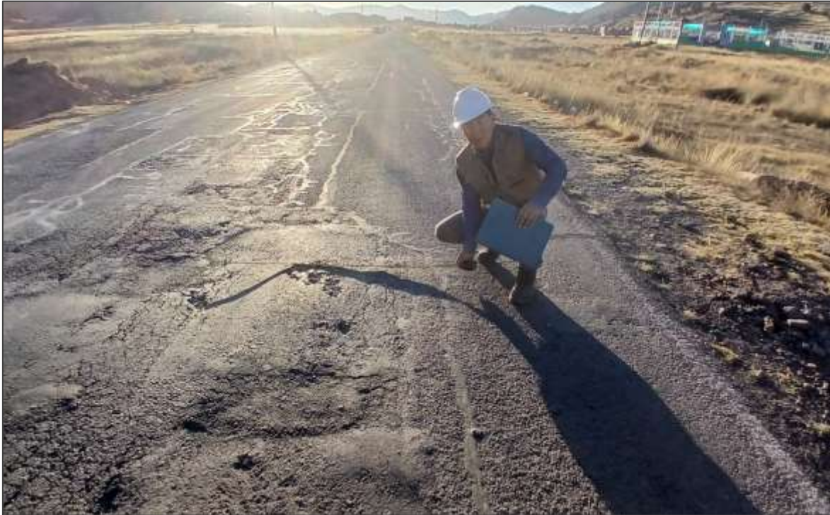
Fotografía N° 19: Tipo de falla parche y abultamiento en severidad alta
