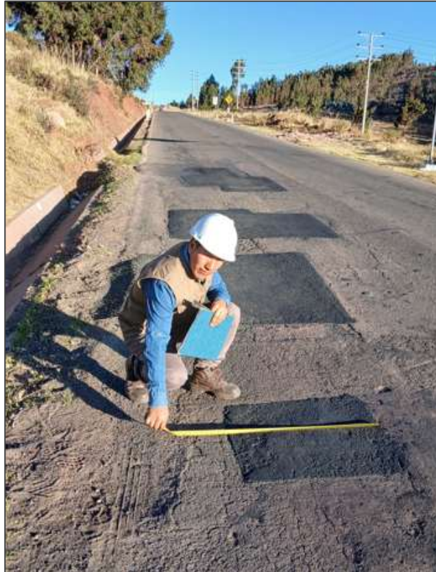
Fotografía N° 07: Tipo de falla parcheo en severidad media
