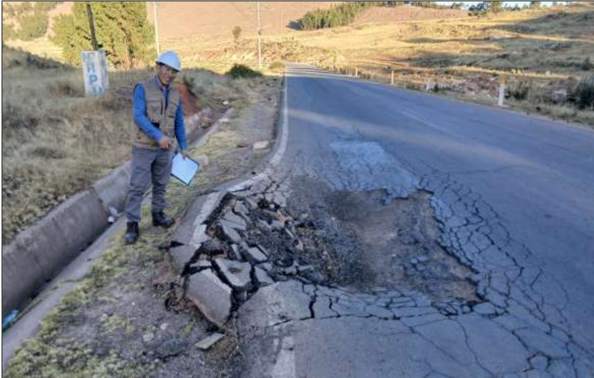
Fotografía N° 23: Tipo de falla piel de cocodrilo y desplazamiento en severidad alta
