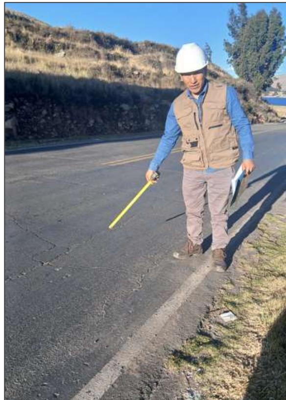
Fotografía N° 12: Tipo de falla fisuras longitudinales y transversales
