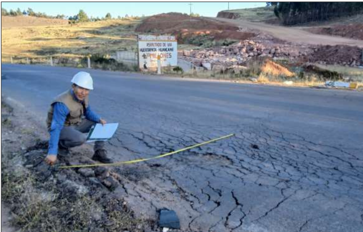
Fotografía N° 24: medición de falla piel de cocodrilo y desplazamiento en severidad alta
