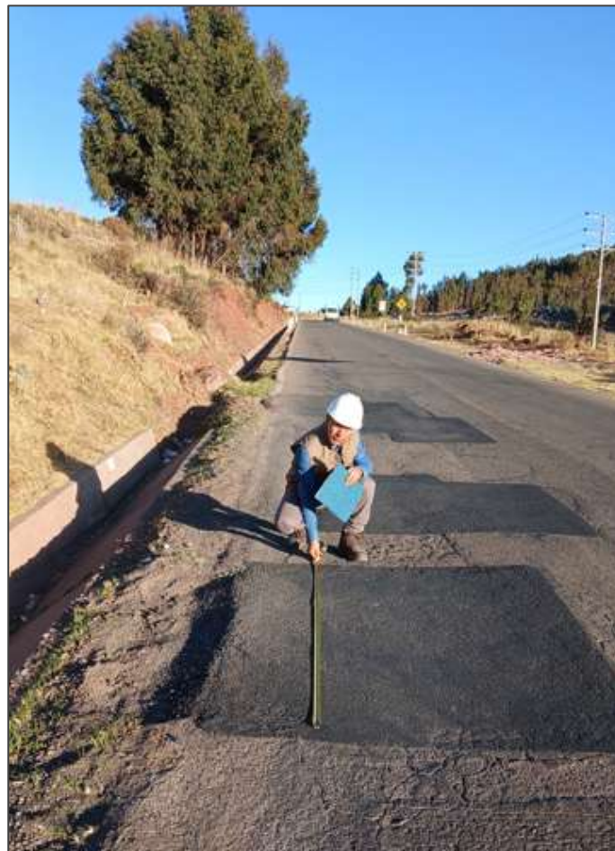
Fotografía N° 20: Tipo de falla parcheo en severidad alta
