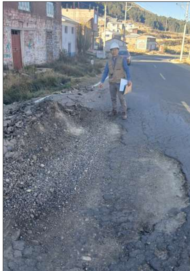
Fotografía N° 10: Tipo de grieta de borde en severidad alta, abultamiento y hundimiento en severidad alta
