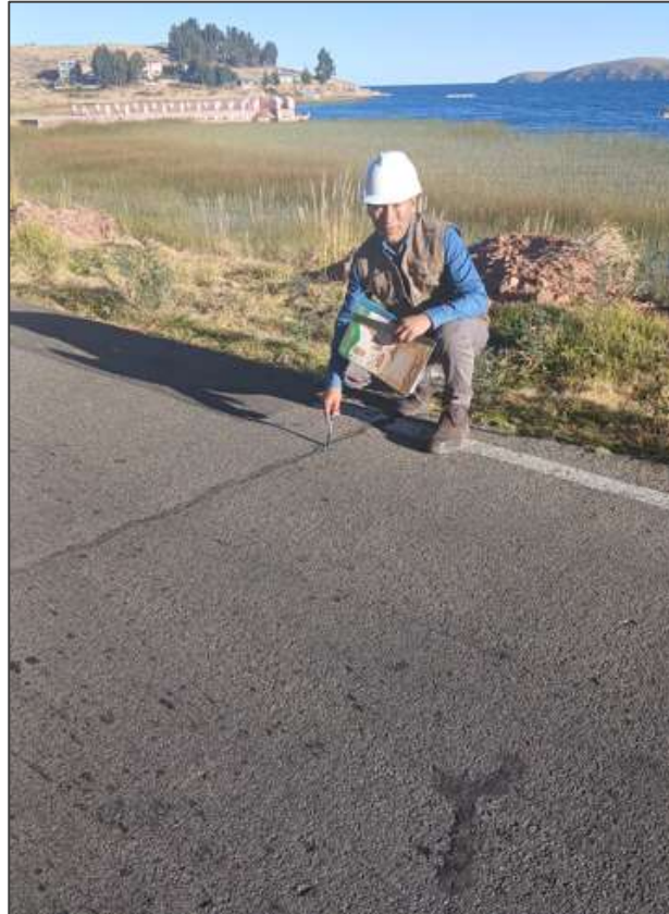
Fotografía N° 13: Tipo de falla fisura transversal en severidad media
