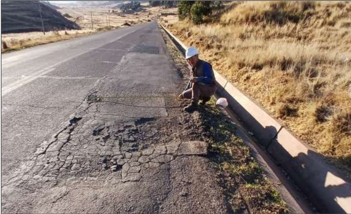
Fotografía N° 03: Tipo de falla piel de cocodrilo en severidad alta
