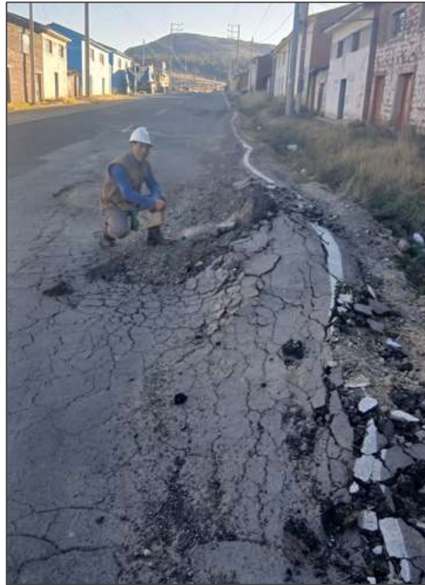
Fotografía N° 11: Tipo de grieta de borde en severidad alta, abultamiento y hundimiento en severidad alta
