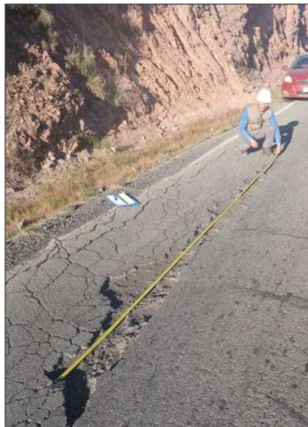
Fotografía N° 16: Medición ahuellamiento con desprendimiento de agregados en severidad alta
