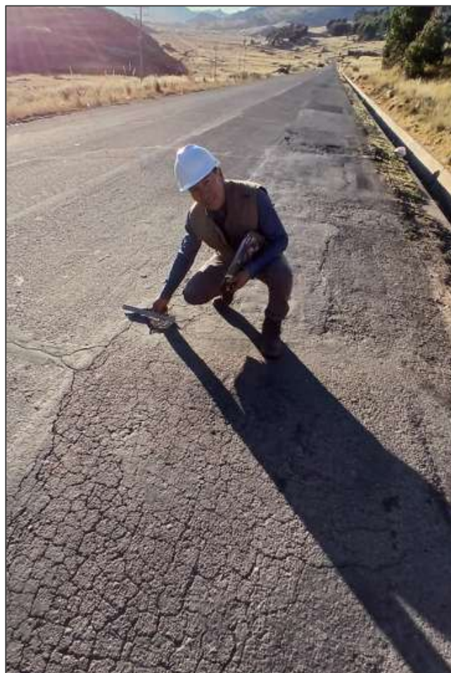
Fotografía N° 04: Tipo de falla piel de cocodrilo en severidad media
