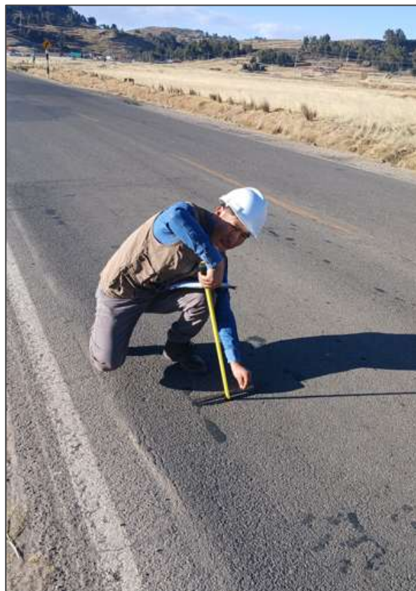
Fotografía N° 18: Tipo de falla depresión en severidad baja
