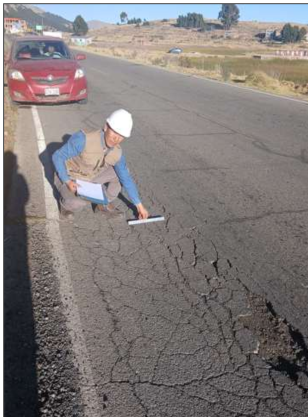
Fotografía N° 14: Tipo de falla ahuellamiento en severidad alta
