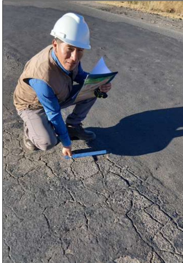
Fotografía N° 17: Tipo de falla piel de cocodrilo en severidad media
