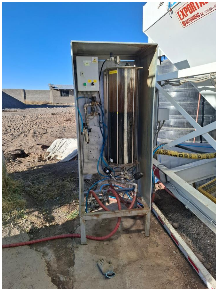
Fotografía 4. Sistema de dosificación del concreto premezclado
