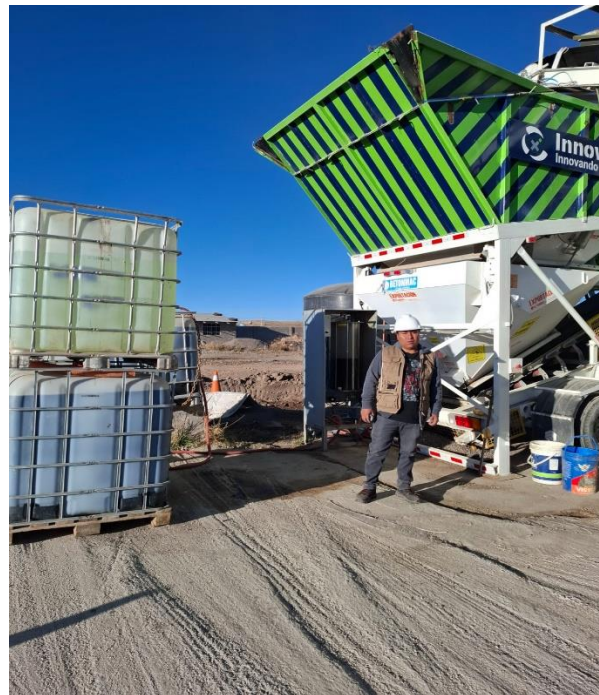
Fotografía 1. Planta de concreto premezclado
